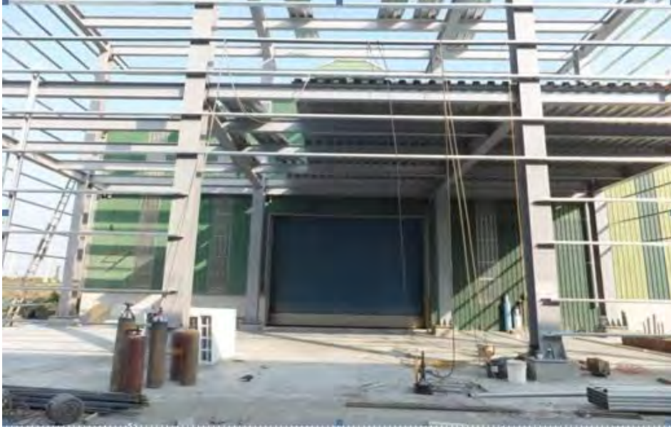
照片 1 冷卻設備廠房浪板及外牆搭建工程，未設置護欄、護蓋或安全網等防護設備，罹災者魏○○自 2 樓西側鋼承板開口處墜落之現場位置（示意圖）。
