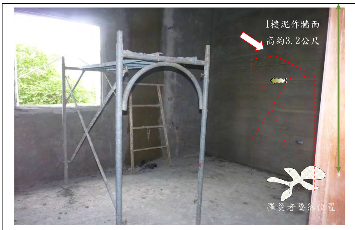
附照1 箭頭處為災害發生時施工架位置，災害發生時施工架向左晃開，罹災者自施工架工作台踏板上墜落後施工架復歸；施工架在搶救過程移至相片位置。
