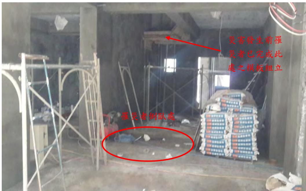
照片 罹災者災害發生時倒臥位置(紅圈處)，位於工地1樓內
