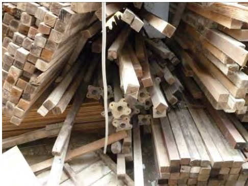
現場檢查發現倒塌之兩大捆角材堆放於不穩固、平坦之鋼管支撐材料上。
