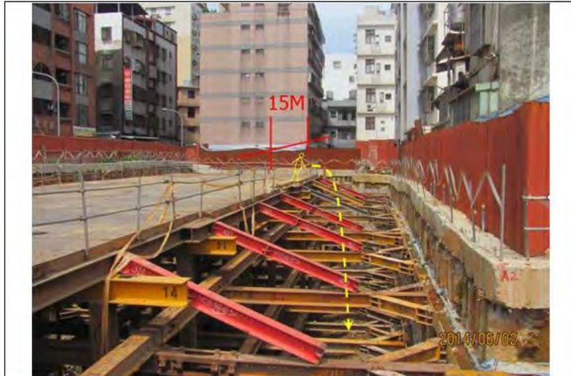
照片 罹災者墜落點位於南側施工構台由左往右算起第 3 根支撐下方，林志豪駕駛挖掘機旁約有 15 公尺長之臨時護欄已遭拆除。
