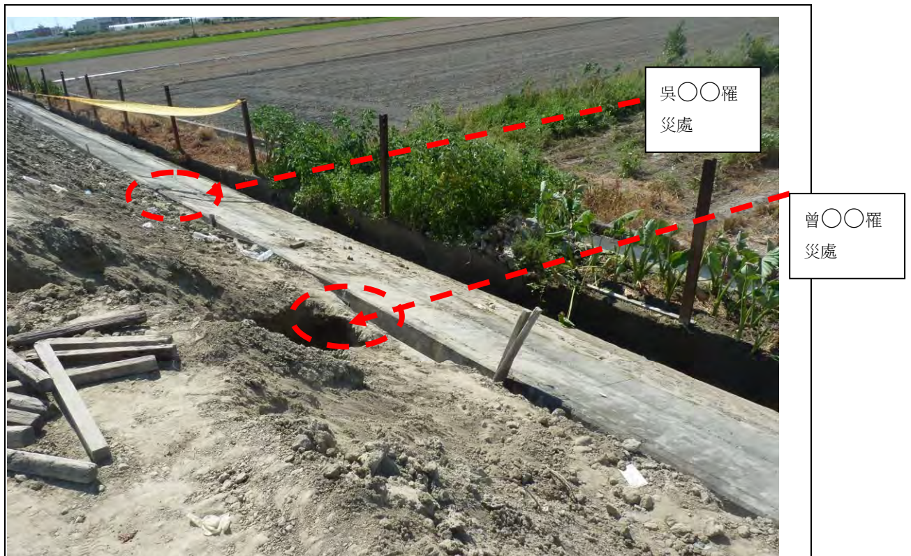
照片1 曾○○、吳○○於清理既有側溝加基礎構造物下方土石時，發生該構造物倒塌，造成曾○○被壓死亡、吳○○被壓受傷。
