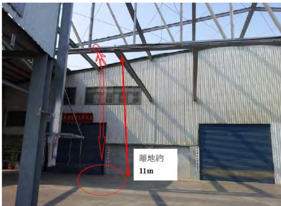
照片2罹災者墜落之屋頂，位於案發工程的北側，距離地面約11公尺，屋頂邊緣未設護欄或安全母索。
