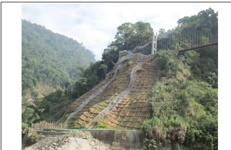
說明 照片 一：災害發生於嘉義縣番路鄉「觸口地區天長橋 災害整修工程
