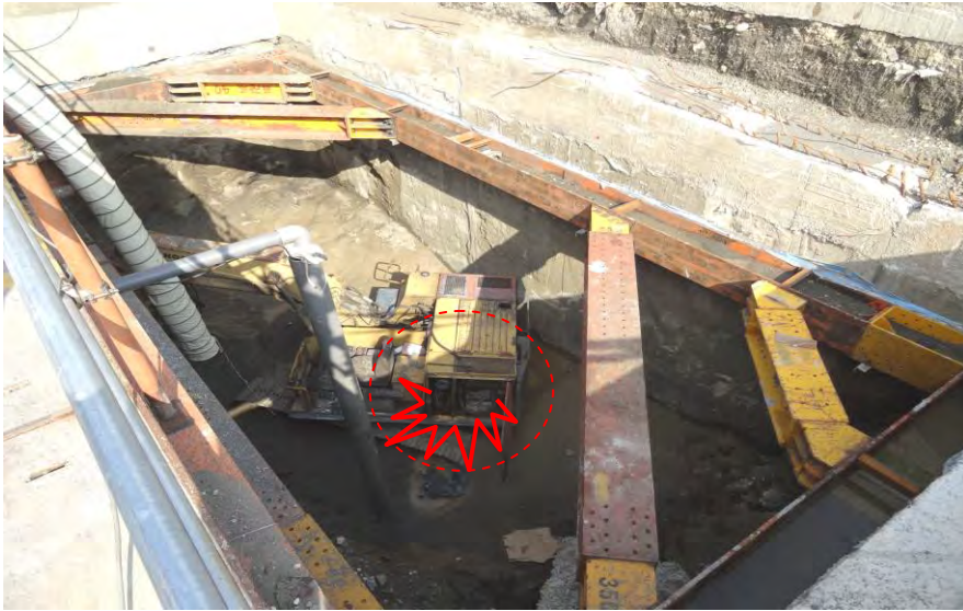
照片4： 災害發生後照片，內燃機側版爆開
