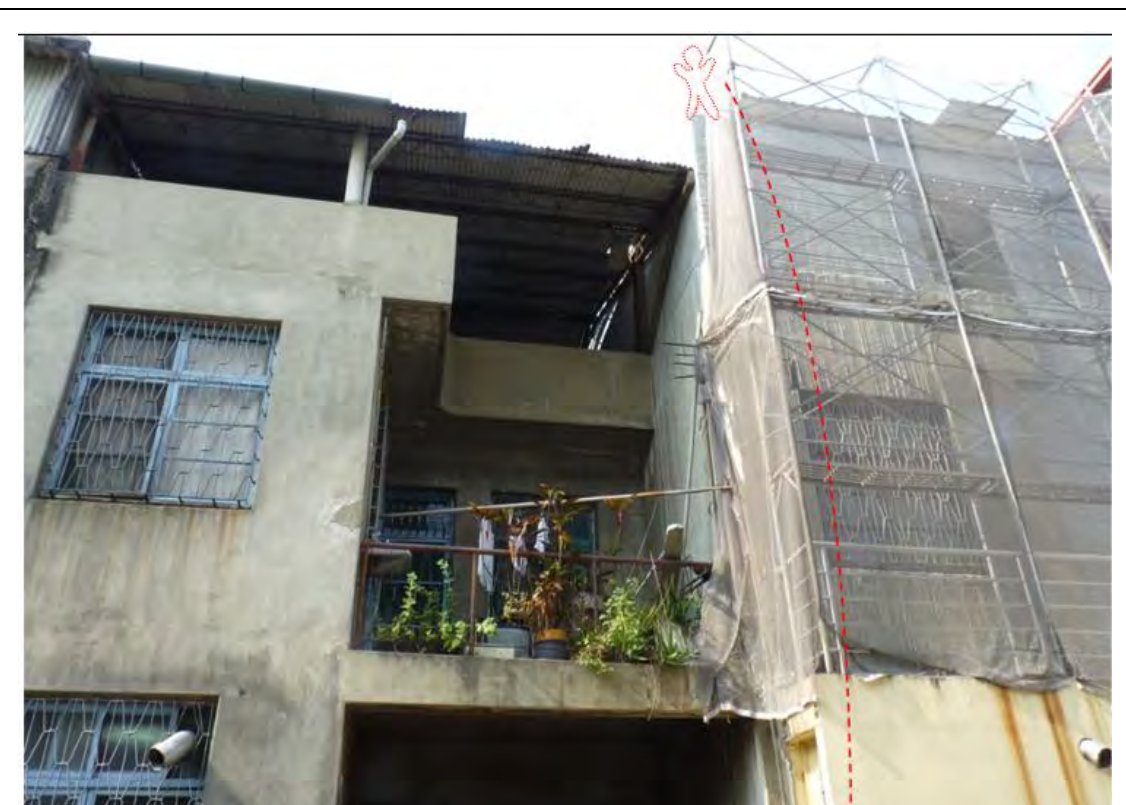
附照2 | 罹災者由3樓屋後屋頂邊緣開口墜落至屋後鄰房空地上(高約10公尺)。
