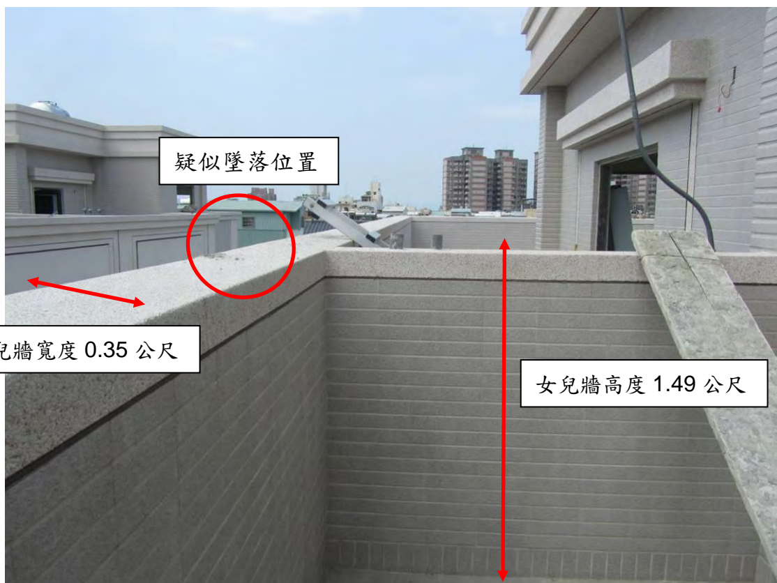
說明 照片3 災害發生處之女兒牆高度約1.48公尺，距地高約17.5公尺，寬度約0.35公尺，災害發生時罹災者邱○明疑似墜落位置（紅圈處）。女兒牆開口未有護欄、安全網等防護設施。
