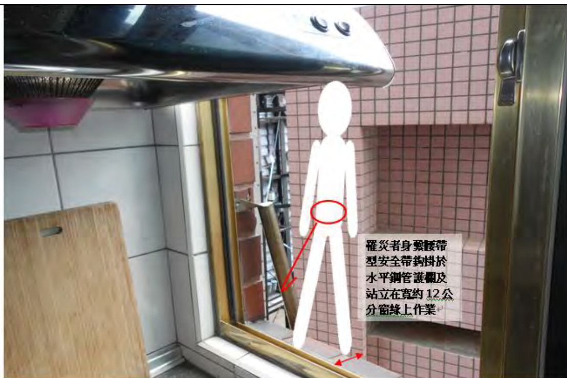
照片1罹災者作業時站立於廚房窗台上，使用之安全帶係鈎掛於窗外水平鋼管護欄(示意圖)。
