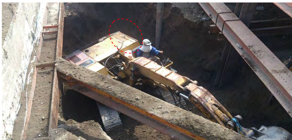
照片3： 災害發生前，內 燃機側版封閉
