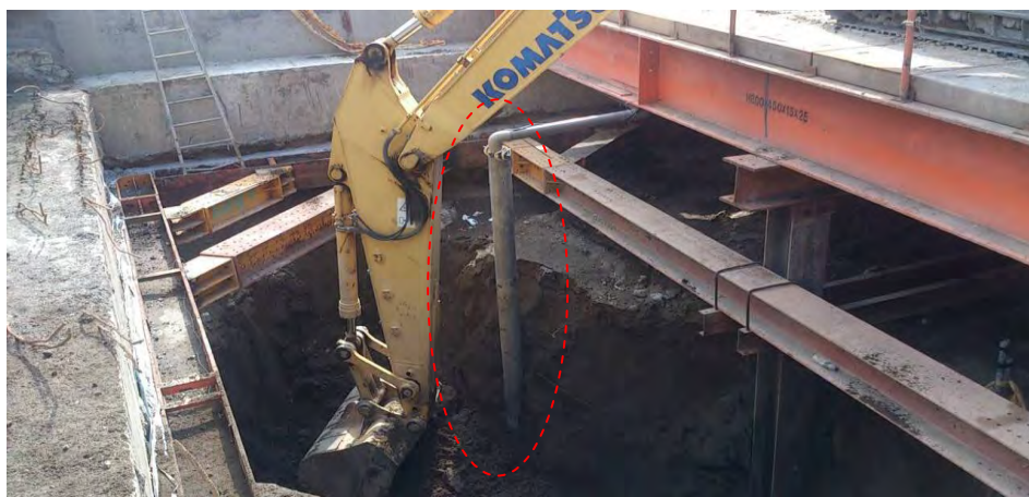
照片1： 災害發生前，抽水 管完整無損
