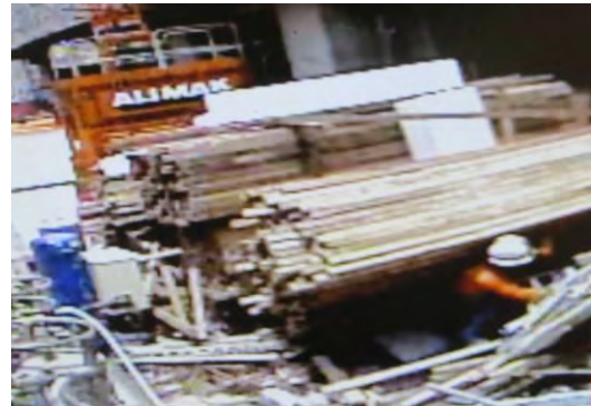
當郭○○傳遞約10片板料後身旁兩大捆角材突然倒塌壓住郭○○。
