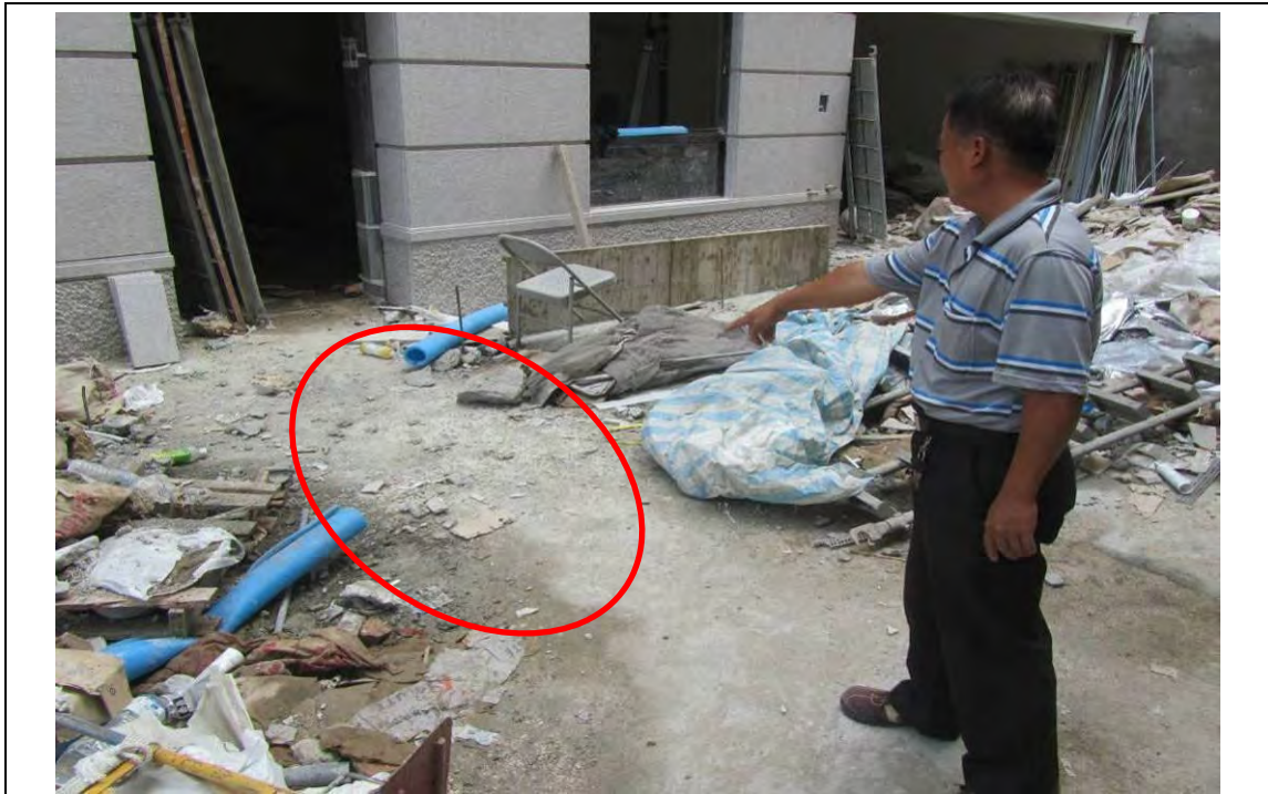
說明 照片2 罹災者邱○明墜落於地面1樓位置。
