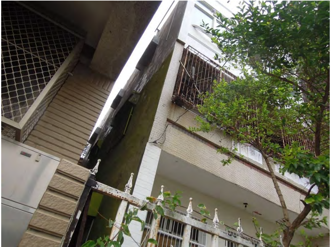
相片1災害現場為3樓舊公寓，災害發生時，罹災者正從事 3樓外牆防水漆塗佈作業
