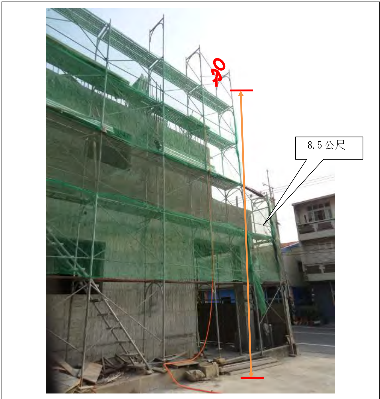
說明 | 照片二：罹災者楊○○係於第5層施工架工作台墜落，墜落高度8.5公尺
