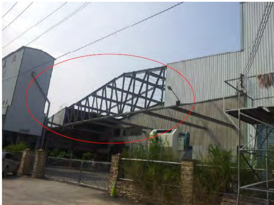
照片1案發工程為倉庫廠房南側延伸之鋼構建築(照片所示為拆除施工後之現況)。
