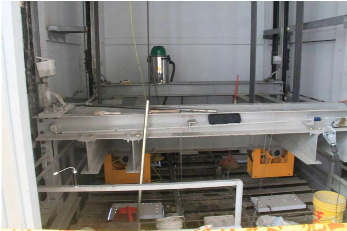
災害發生時此搬器上方狀況
