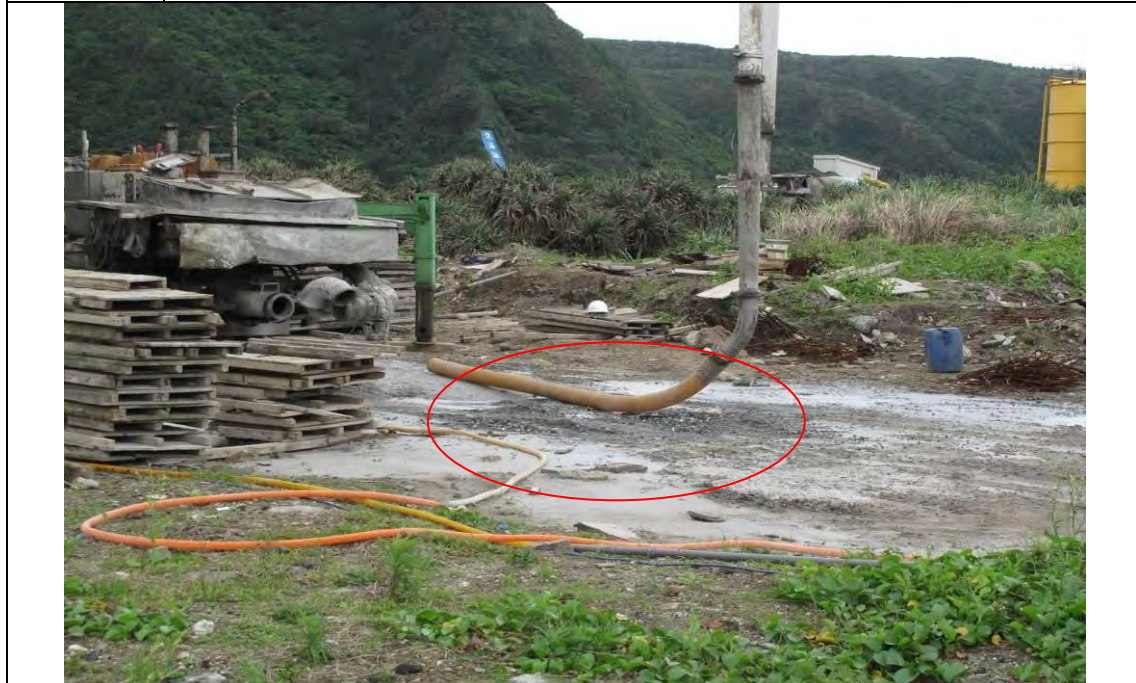
說明 照片5. 混凝土壓送車輸送管之尾端軟管長3.3公尺，直徑0.12公尺
