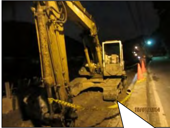
發生災害現場。(該挖土機為肇災之車輛系營建機械)
