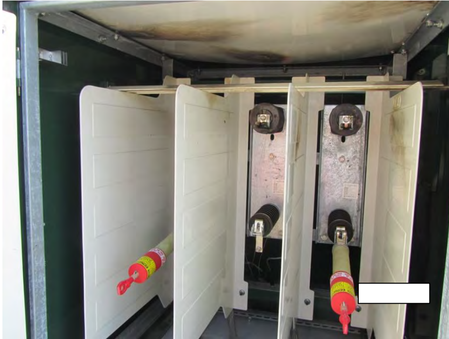
罹災者右手與電力保險絲電源端接近時發生閃絡感電事故之開關箱配置情形。
