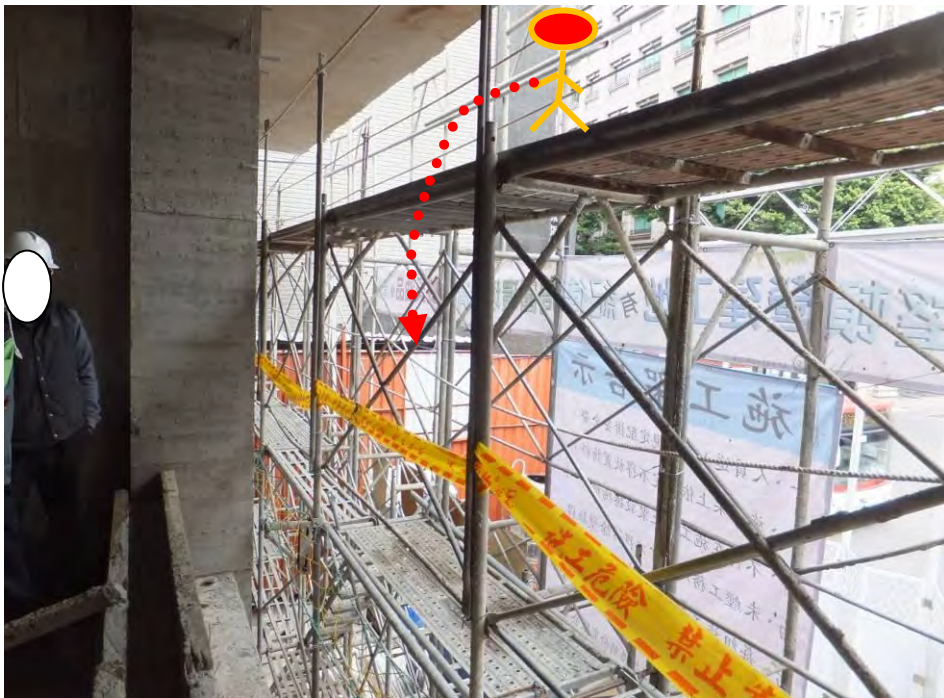
說明：罹災者自施工架上墜落
