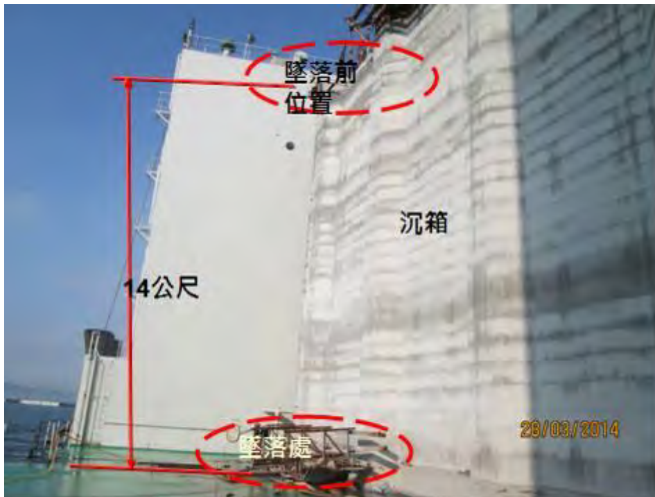
災害發生處全景
