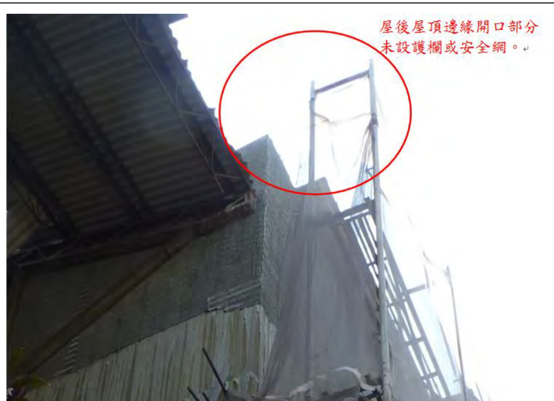
附照1 | 屋後屋頂邊緣開口部分未設護欄或安全網等防護設備。
