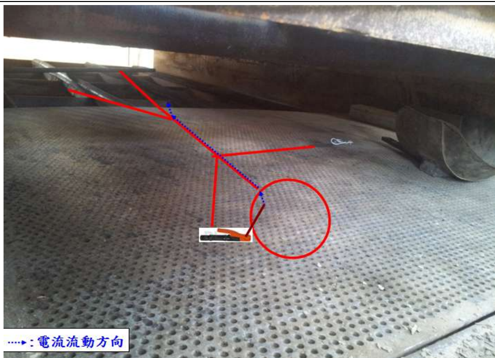
照片二 罹災者身體趴臥在下層不銹鋼篩網上，欲利用電焊機進行下層不銹鋼篩網開孔作業，罹災者被發現時已昏倒在 5 尺震動篩選機內之不銹鋼篩網上。
