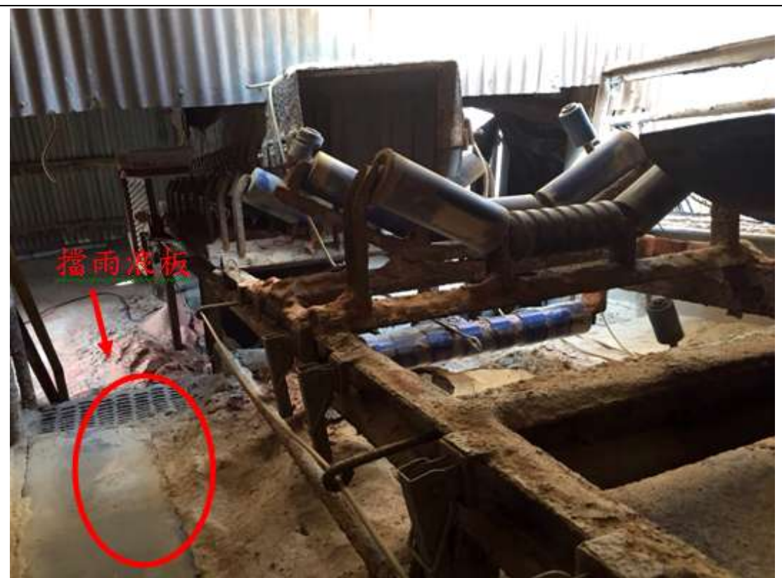
說明二 勞工蔡○○當時拉下擋雨浪板掉落至輸送帶旁。
