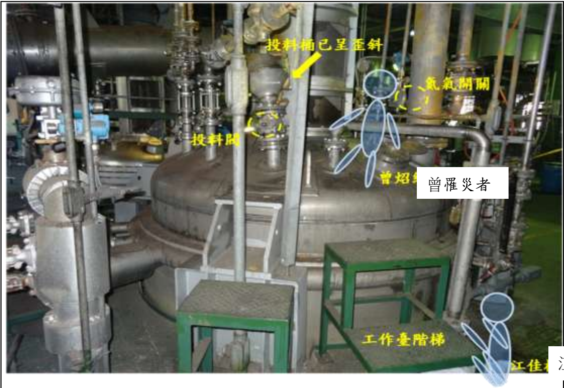
照片 1 爆炸後曾耀災者頭部撞擊管線及江耀災者跌落至地板。
