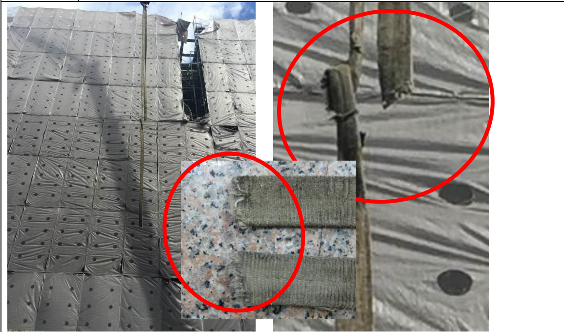
說明 照片五：使用之纖維帶寬5公分，單條之安全荷重為2噸，破壞荷重為10噸，2條纖維帶之斷裂點為同一長度位置，斷裂面呈整齊切斷形狀。(由○○營造有限公司提供)
