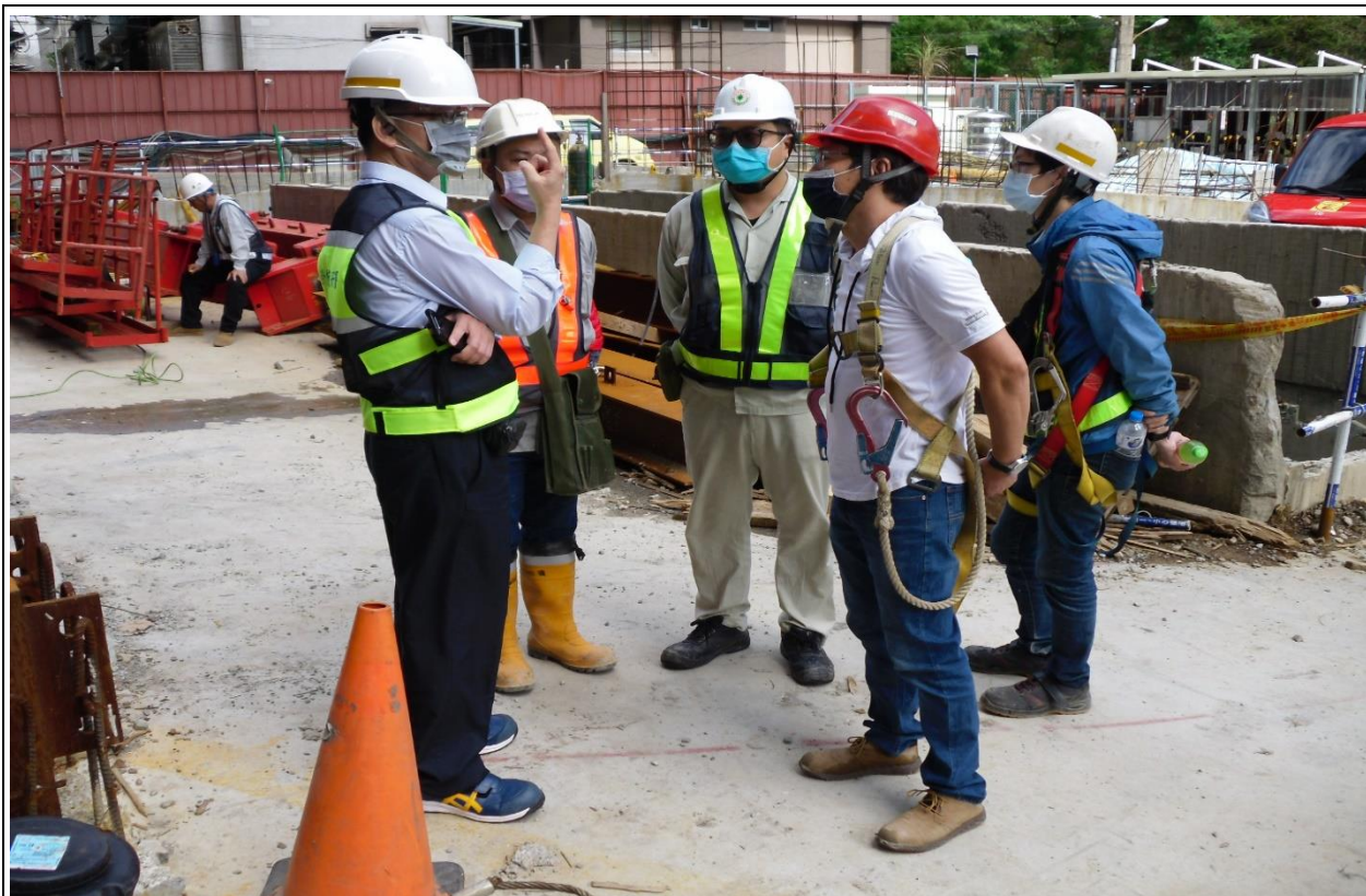
本署朱金龍副署長率檢查員前往北部營造工地實施區域巡檢。
