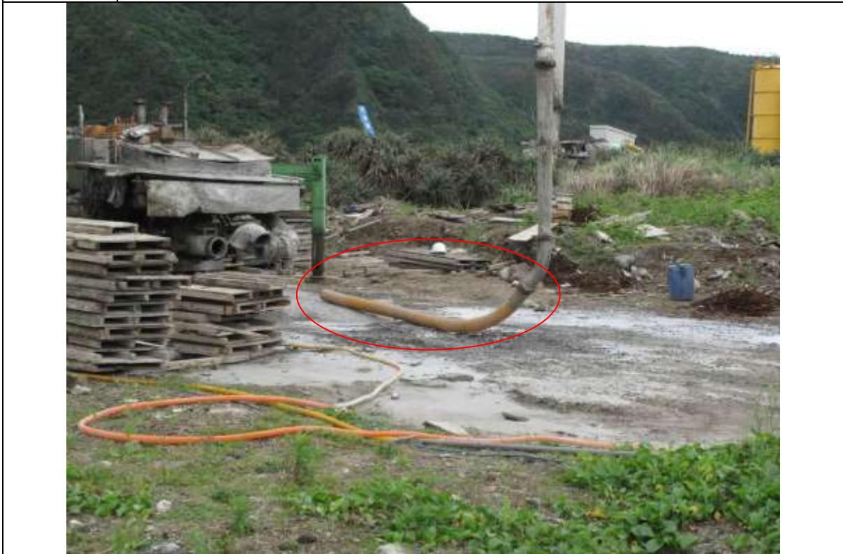
說明 照片 5. 混凝土壓送車輸送管之尾端軟管長 3.3 公尺，直徑 0.12 公尺
