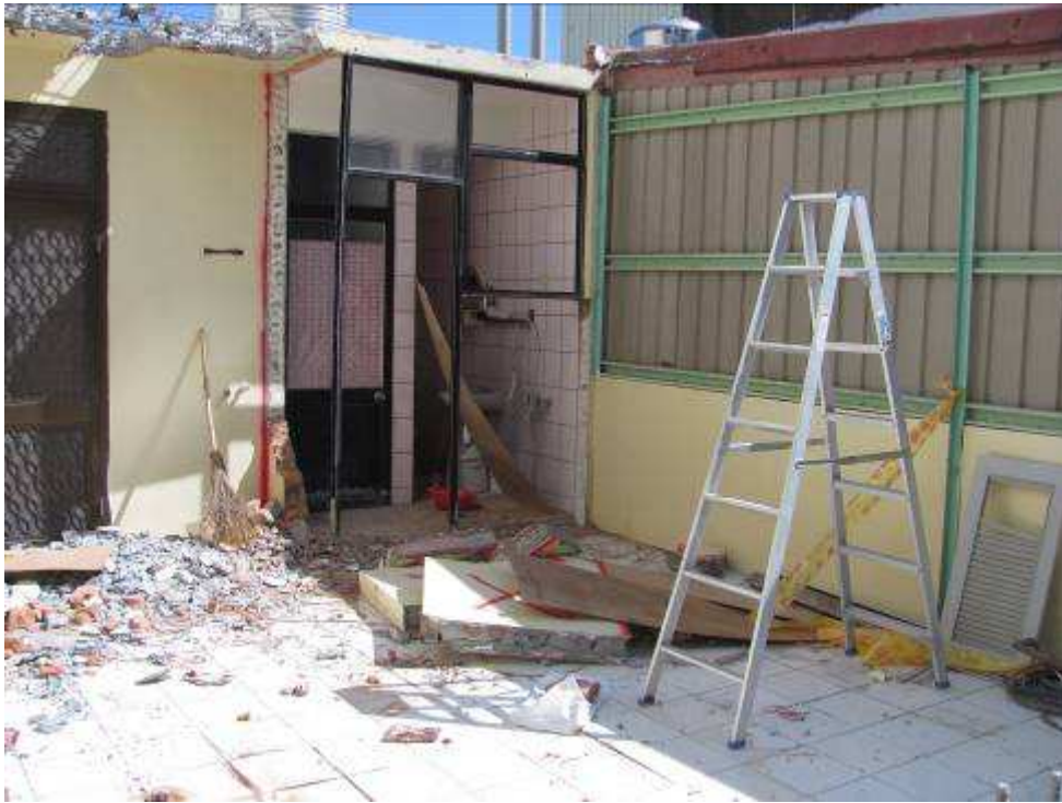
說明 災害現場立面照片
