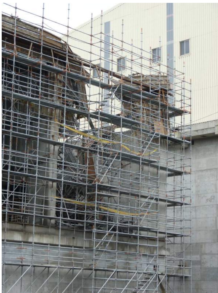
說明：災害發生場所位置（發生災害建物稱謂西平台）
