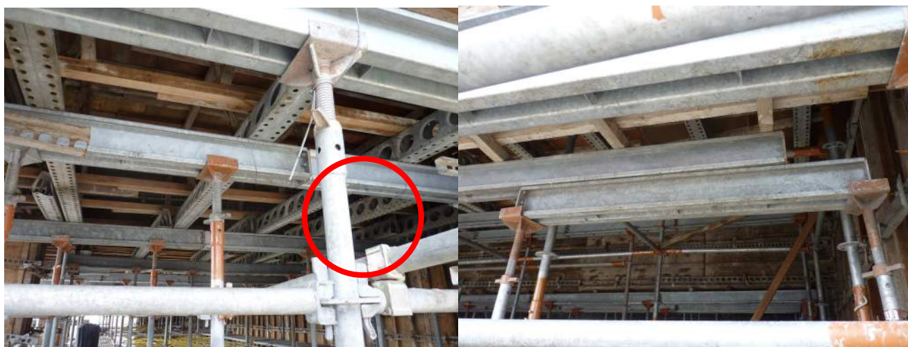
說明：托架與鋼材及鋼材與鋼材間未以螺栓或鉚釘等金屬零件固定
