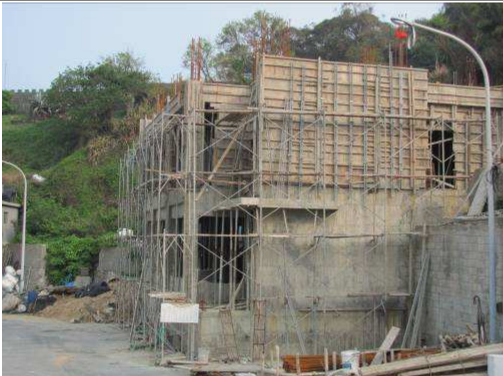
說明 災害現場立面照片
