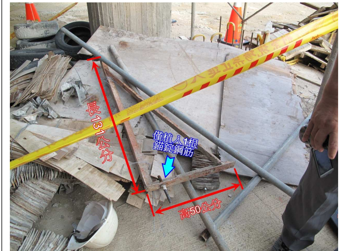
照片 2 | 掉落一樓樓版之三角托架長 131 公分,高 50 公分,僅植入 1 根錨錠鋼螺絲。
