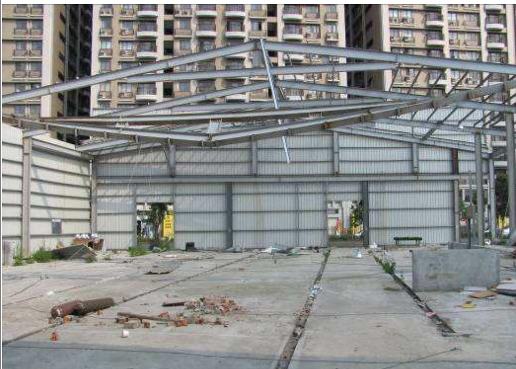
說明 災害現場照片
