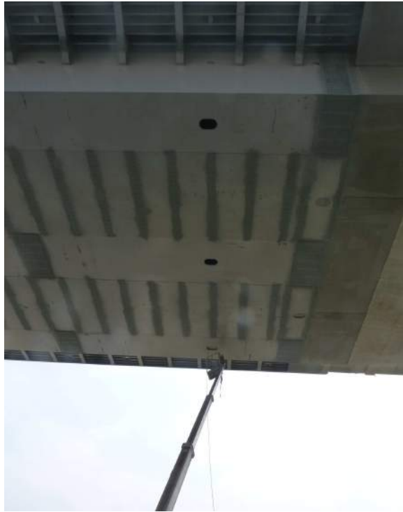
說明 氣爆發生後高空作業車遭受衝擊變形
