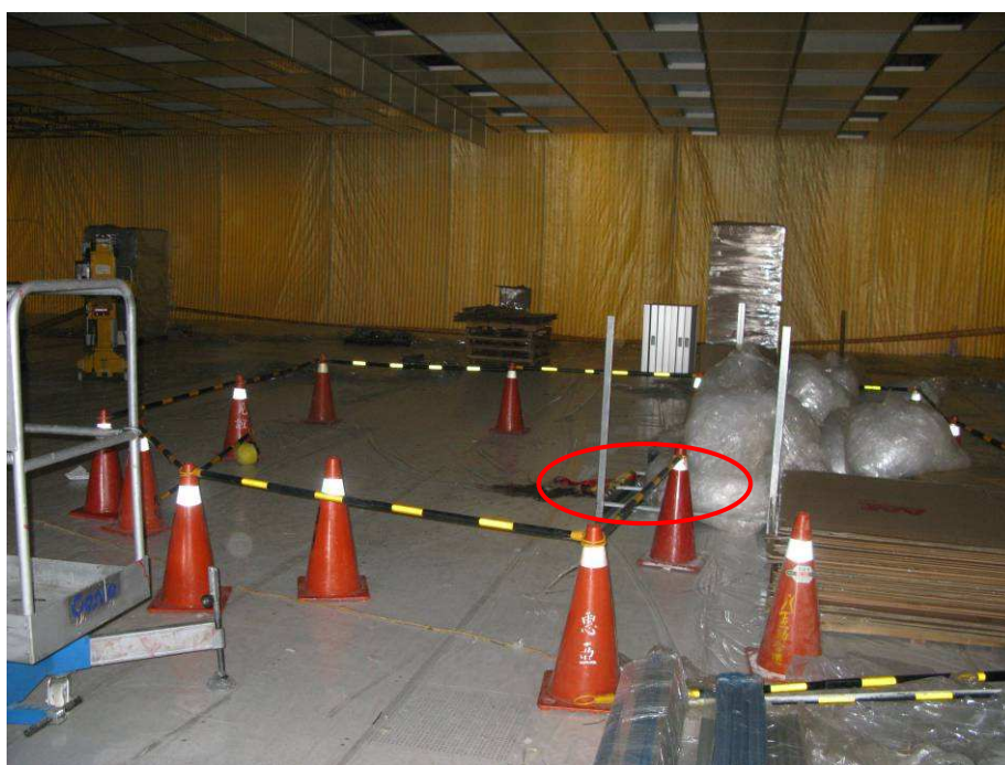
圖六、現場災害發生地點(罹災者墜落 FAB 棟 30 層(地板)之位置)
