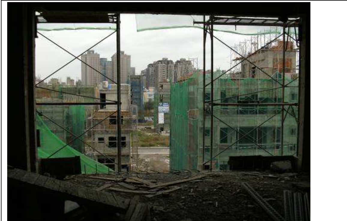
說明 災害現場立面照片
