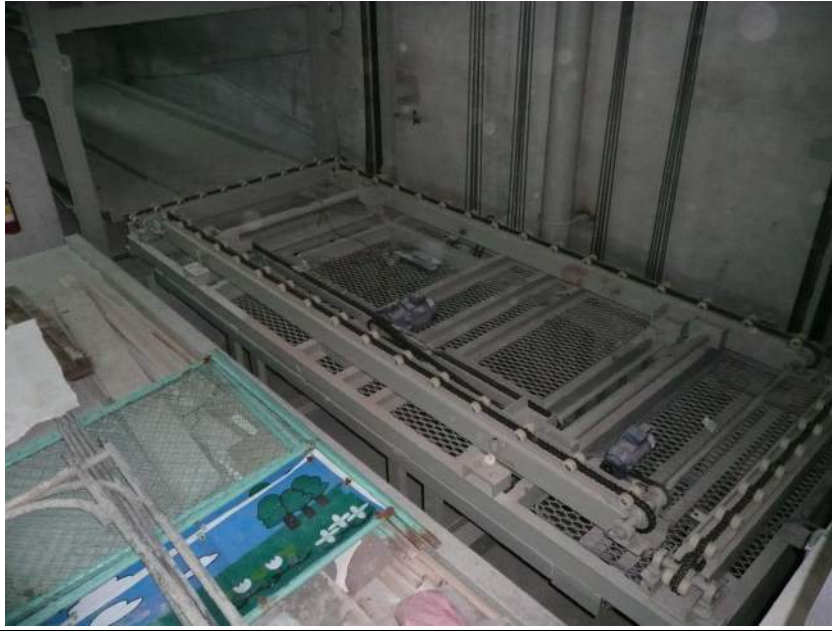
說明二 罹災者墜落處-停車設備平台撐座
