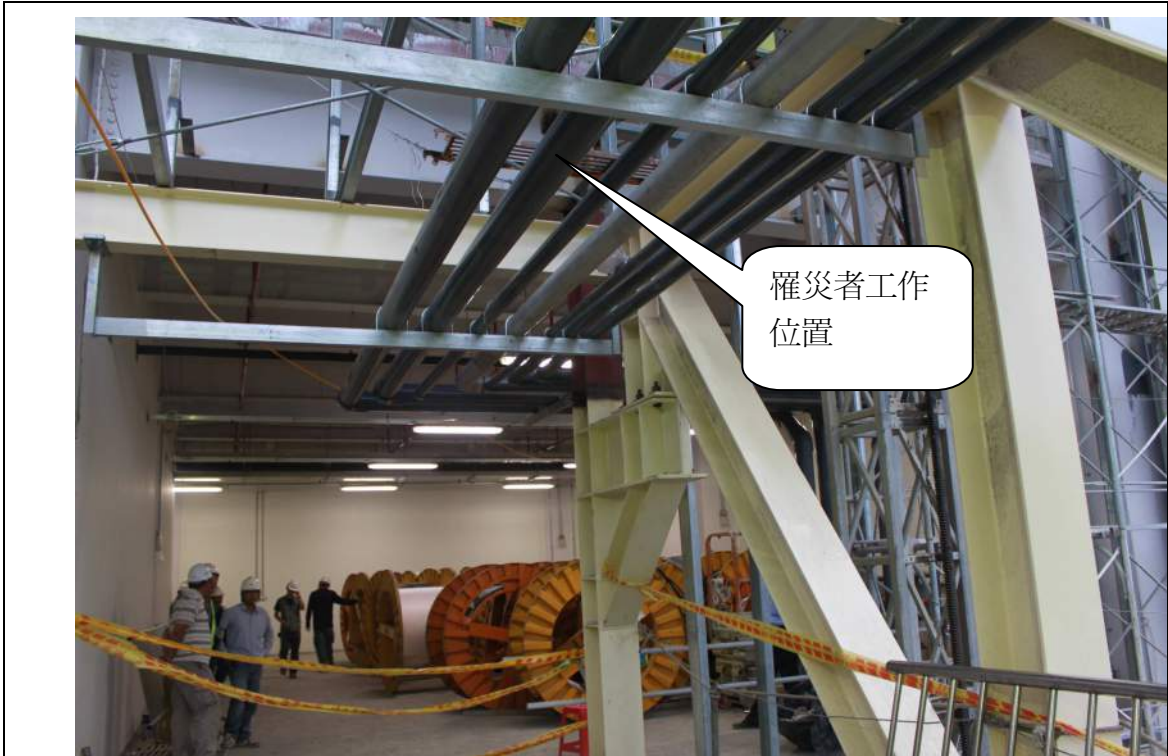
照片一 空橋管線上視圖，由二樓往上看。
