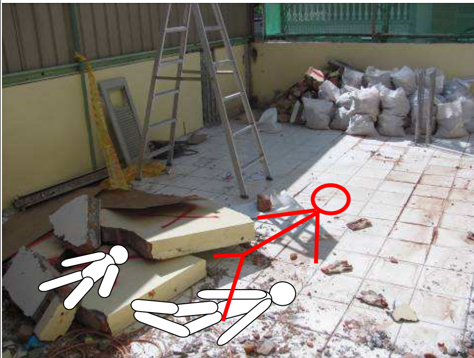
說明 災害現場照片
