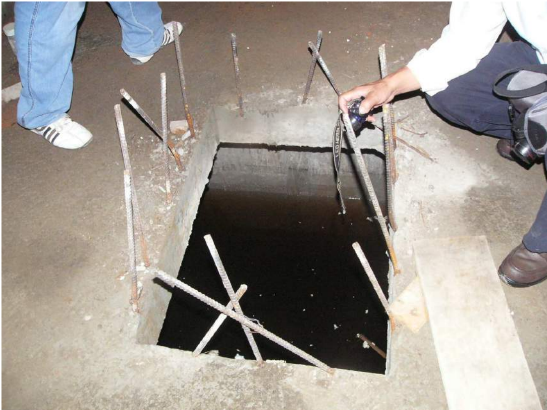
照片 2 集水坑內有積水
