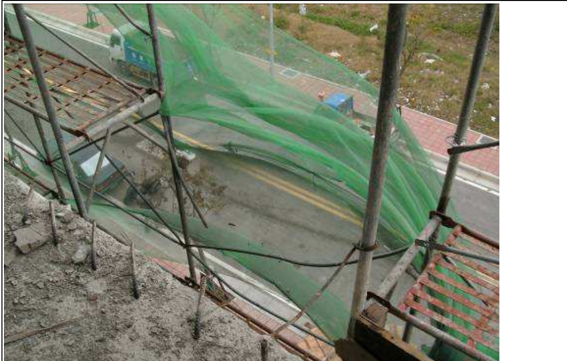
說明 災害現場照片
