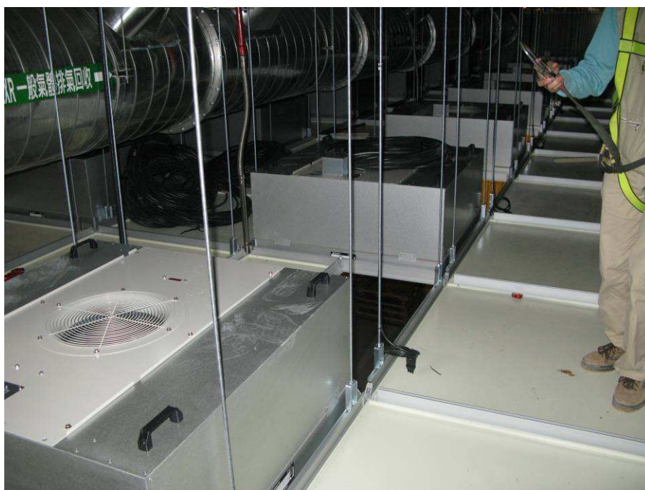
圖五、災害現場周遭位置(FAB 棟 35 層(天花板)8.5~9/H.5~J 柱位間)
