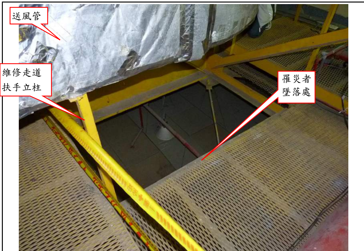
說明 附照 2，罹災者墜落處：屋頂維修通道。其他維修通道可見扶手；惟此災害發生處無扶手。
