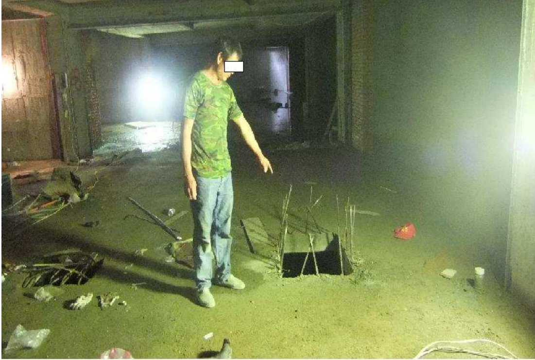
照片 1 肇災集水坑
