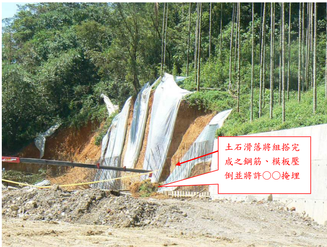
附照 2 鋼筋、模板遭土石滑落壓倒
