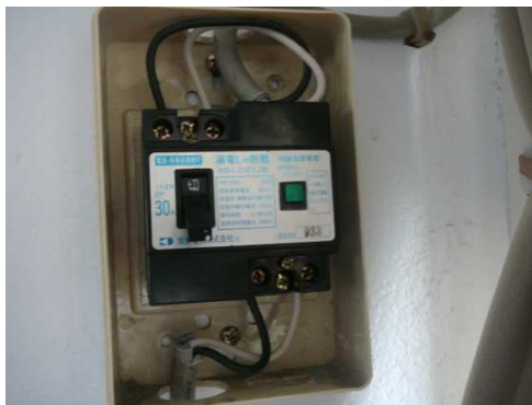
照片三 災害現場水 槽連接之插頭及插座(未有接地孔)及電源所裝設之漏電斷路器(災害發生後裝設)
