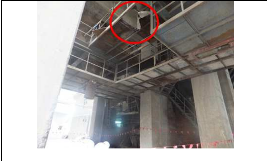
照片說明 2：罹災者墜落處，留有開口長為 1.1 公尺、寬為 0.6 公尺。
