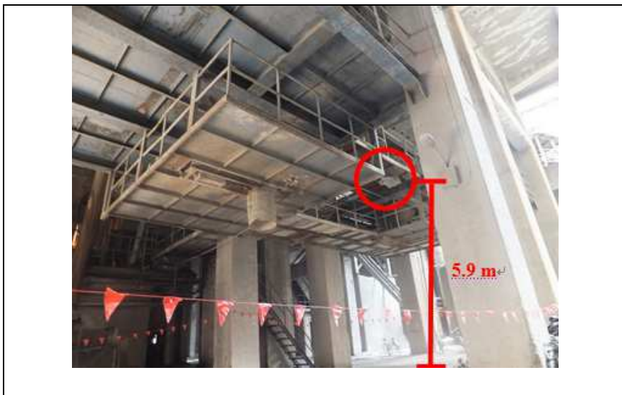
照片說明 1：罹災者踏穿遭腐蝕鐵板而墜落(高度：5.9 公尺)。
