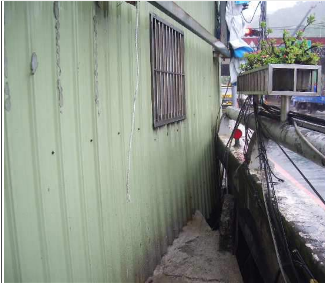
照片說明 1：罹災者自鐵皮屋與橋面間隙開口發生墜落
