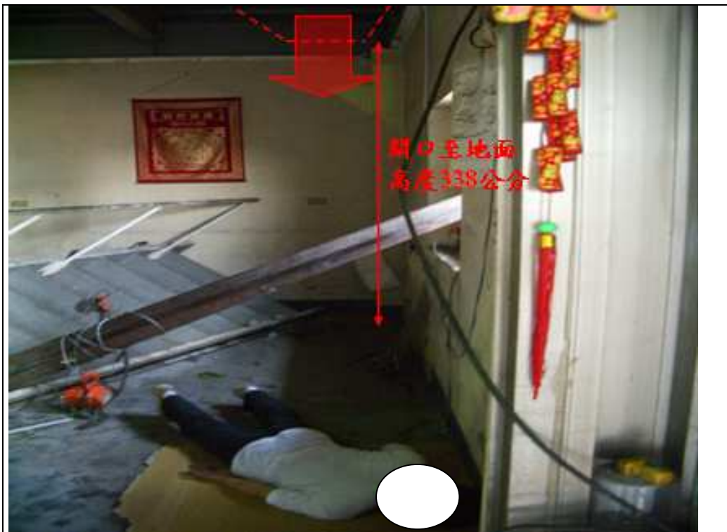
照片說明 1： 模擬罹災者自 2 樓樓板開口處墜落地面之示意圖，2 樓樓板開口至地面高度約 338 公分
