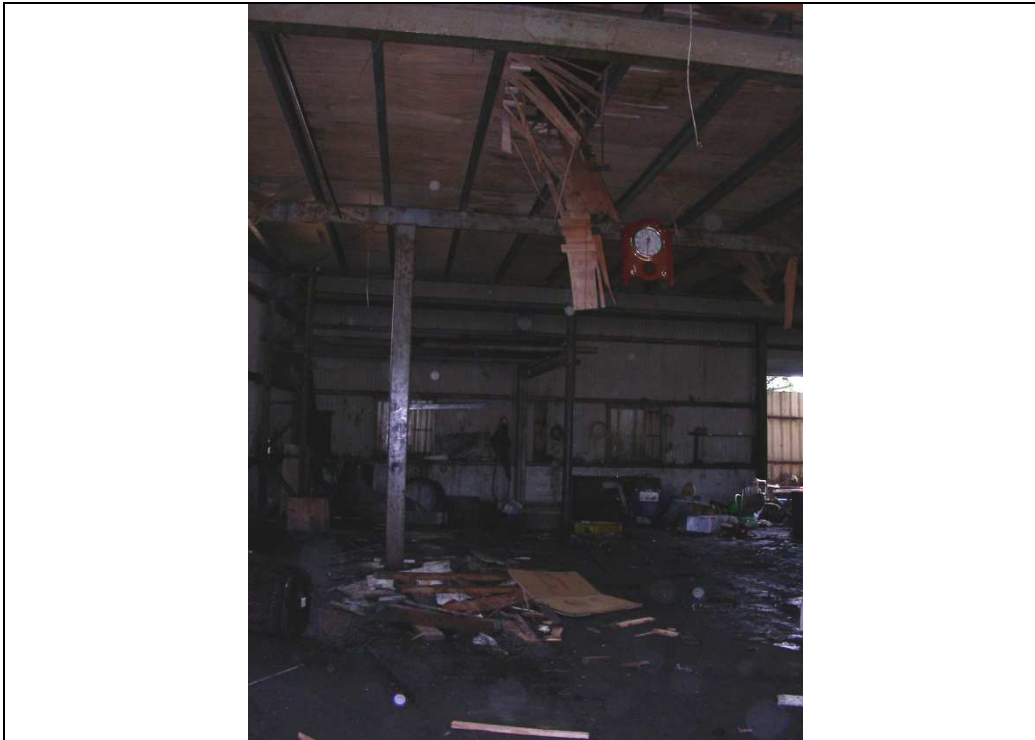
照片說明 1：罹災者洪 00 自離地面高度約 3 公尺之夾層地板，踏穿地板墜落地面
