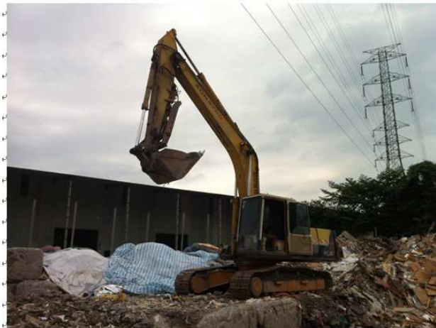
照片說明 1：模擬肇災前力○○將挖土機之 臂升到最高，使挖臂及挖斗停留在空中情形。
