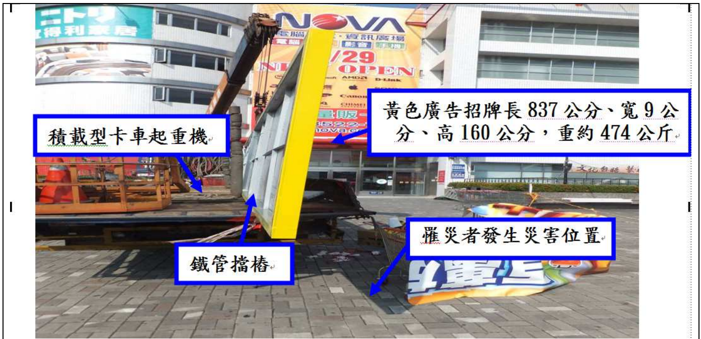
照片說明 1： 災害發生地點處相關設施、移動式起重機、廣告招牌、及罹災者發生災害之位置
