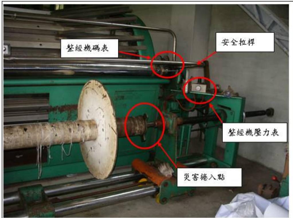
說明一 | 災害發生整精機之捲入點、安全拉桿、碼表、壓力表位置。
