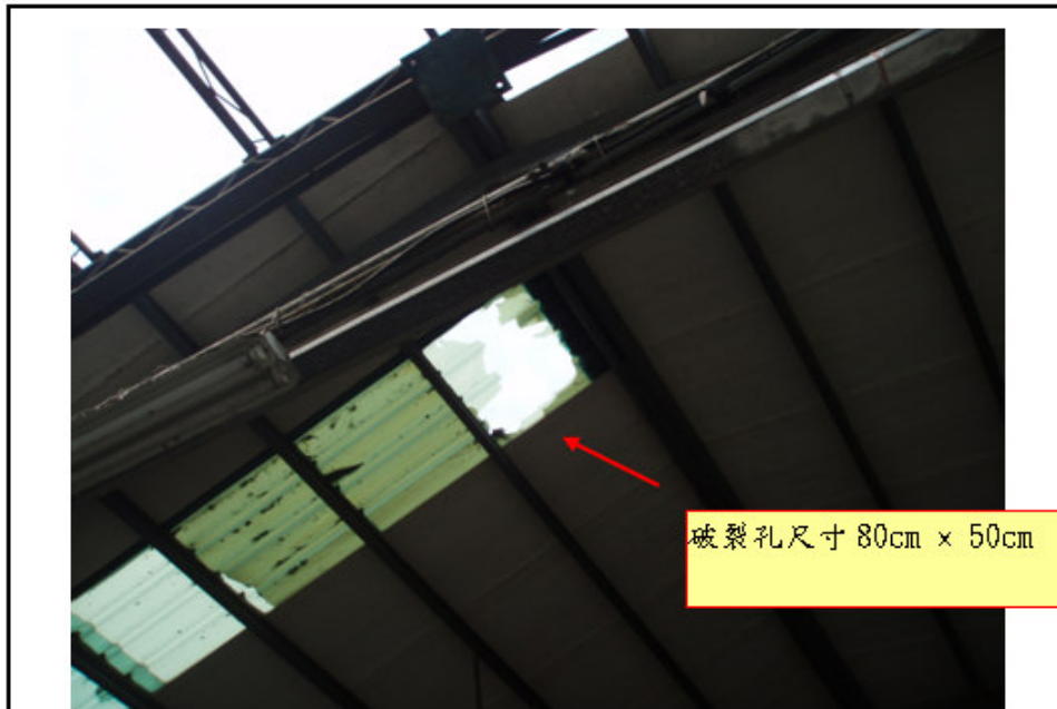
說明 照片 1：肇災地點為○○冷凍食品股份有限公司廠房，踏穿塑膠材質浪板之高度距地面約 5 公尺，踏穿之破裂孔長約 80 公分、寬約 50 公分。
