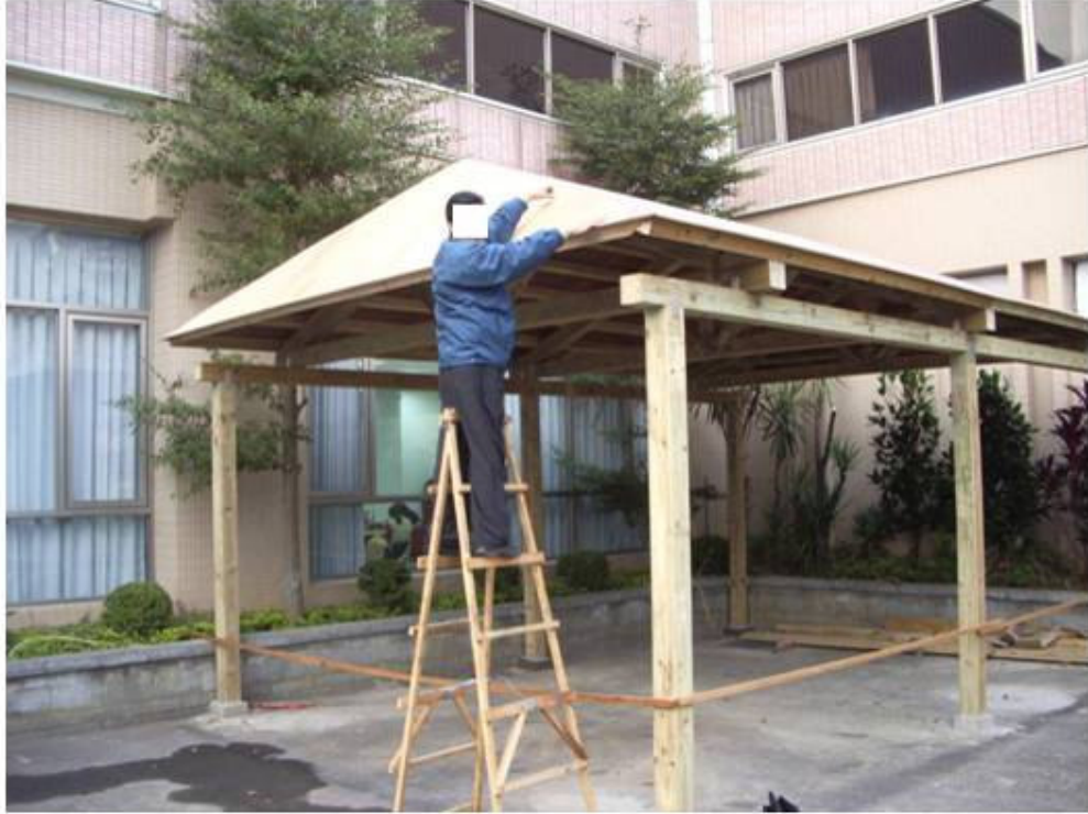
模擬罹災者當時拿著三夾板在度量三夾板尺寸是否與涼亭屋頂空隙處是否相合之情形。
