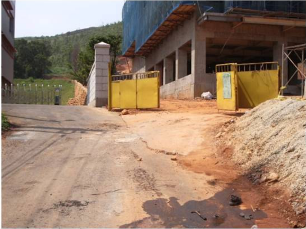
災害發生位置(下坡往上坡拍攝)
