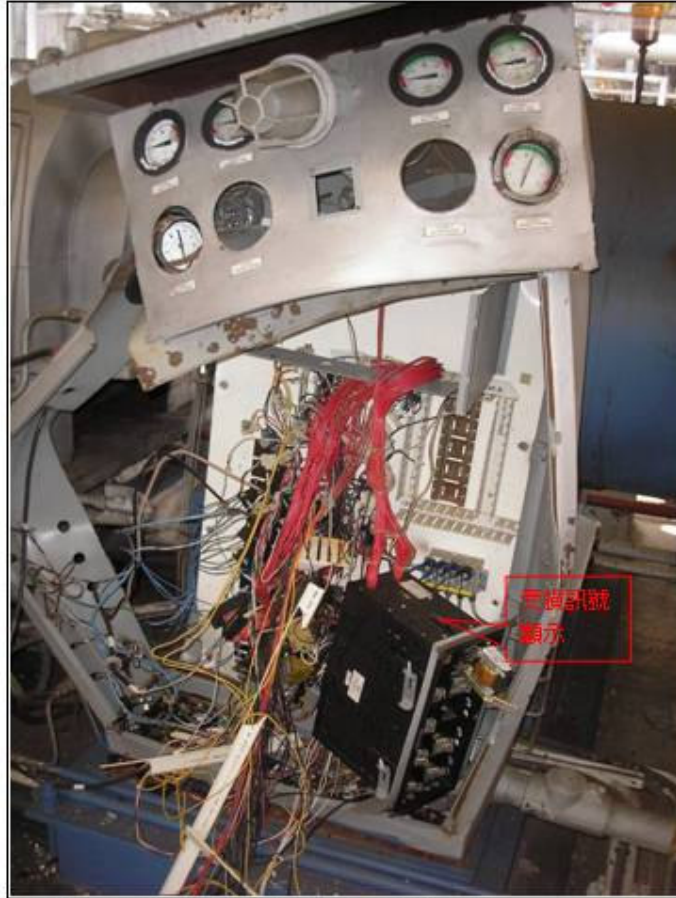
附圖 受損電氣控制箱盤內毀損情形
