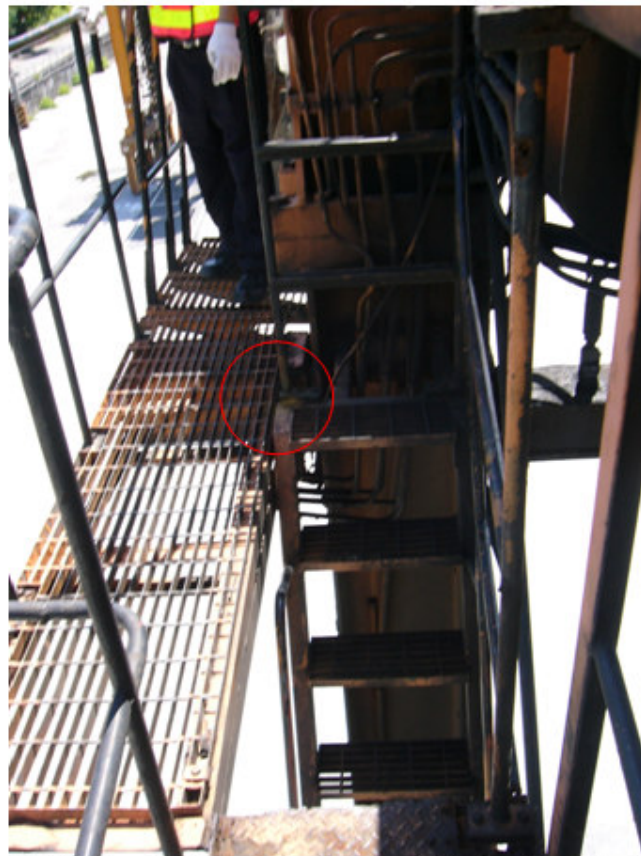
通道至上下設備間第一階梯約 3 公分落差(紅圈處)；每一梯階高差約 30 公分
