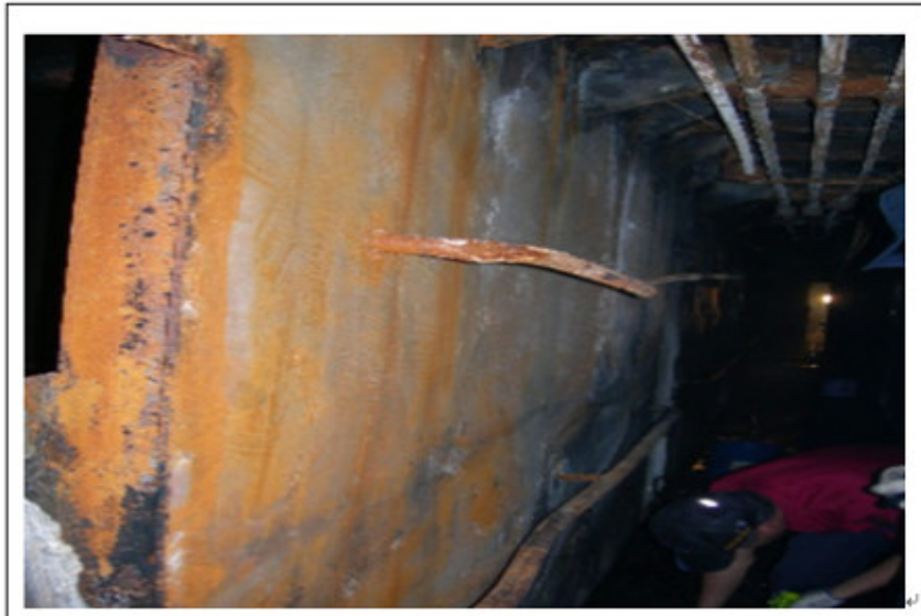
船內臥艙之通道兩側壁面已被大火燒成變形。+
