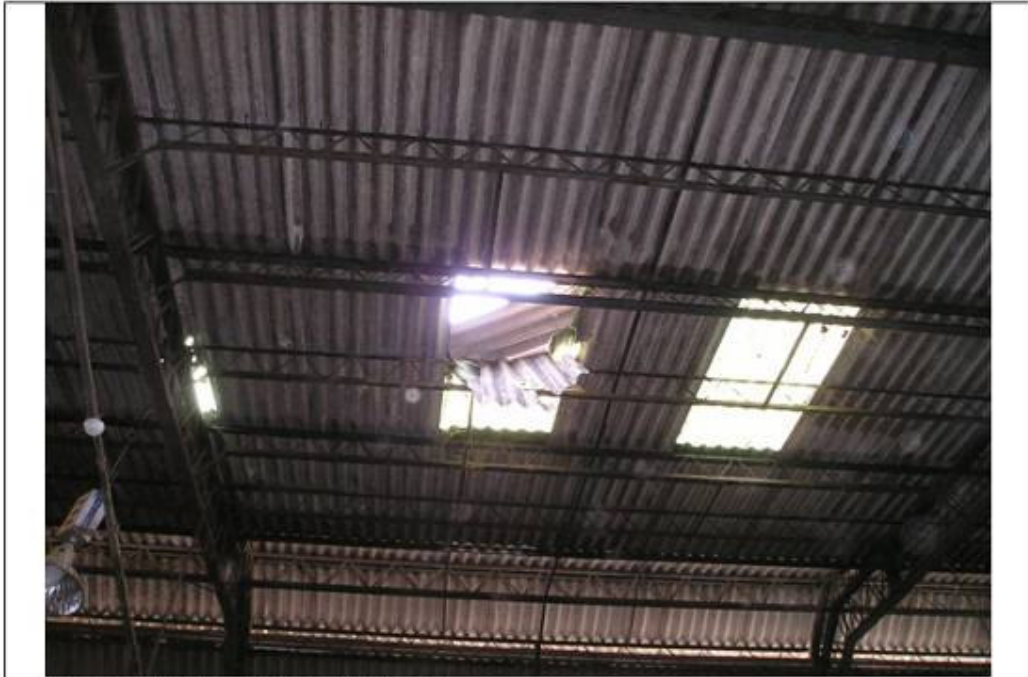
照片說明：罹災者踏穿處為採光屋頂。
