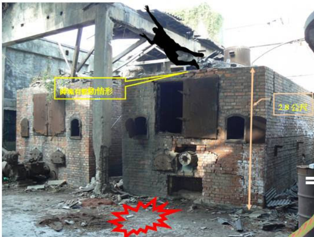
於垂直高度約 2.8 公尺之鍋爐頂板從事拆除廢鐵作業墜落地面死亡。
