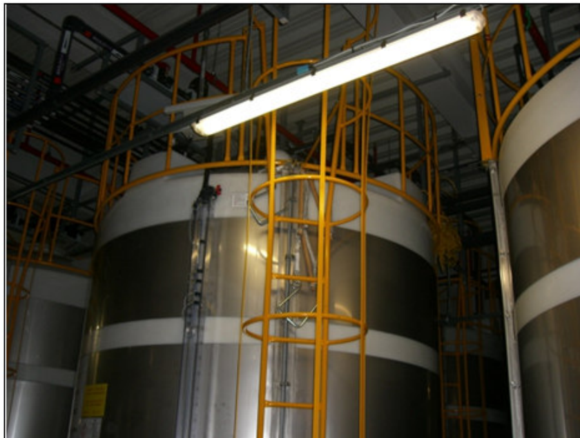
說明 災害現場：廠區5樓鹼性化學房顯影液桶槽外觀。
