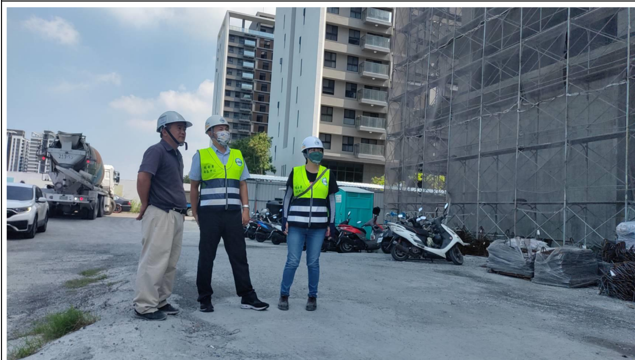
職安署南區職業安全衛生中心林培司副主任率檢查員前往臺南市某建築工地實施勞動檢查。
