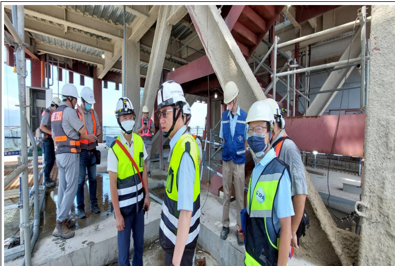
職安署陳志祺簡任技正與臺北市勞動檢查處梁蒼淇處長率檢查員前往臺北市某建築工地實施勞動檢查。
