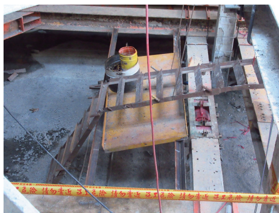
▲ 鋼樓梯崩壞後左側側視照。
