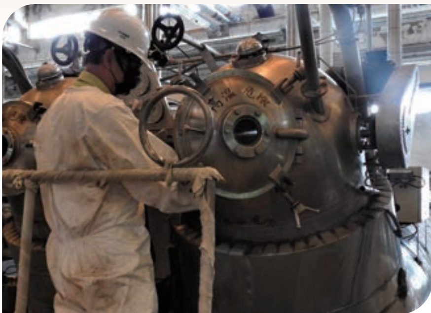
◎ 代檢員對第一種壓力容器實施胴體測厚及焊道目視檢查
