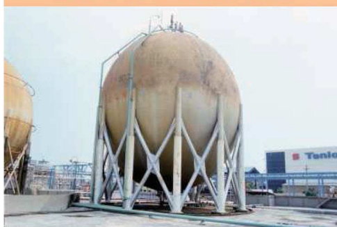
儲槽原無消防灑水裝置
