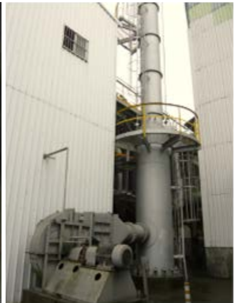
電熔爐集塵設備最後方的集塵室與煙囪。
