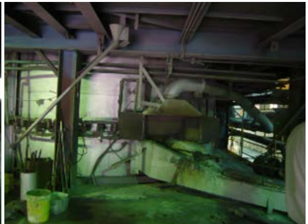
出鎳水區，出口處裝有局部排氣集塵設備，但是周圍仍有許多粉塵；此外，局部排氣的門常常沒關，且抽風效果不好，出鎳水時，會將未完全燃燒的鎳粉一起帶出。鎳水的引道過長，員工需要使用照片左邊的通條，隨時疏通引道，造成粉塵飛揚。
