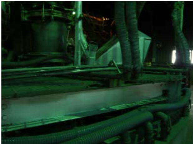
電爐上方管路包覆隔熱棉，早期使用石棉，且須員工定期更換。（三樓爐頂區）
