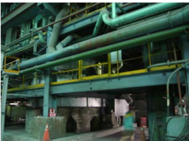
管線後方的圓筒型建築物為電熔爐，有三層樓高。
