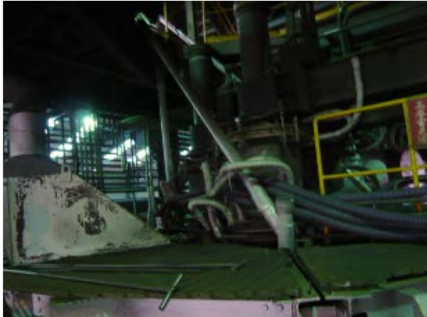
電熔爐爐頂，斜走的入料管路，為密閉的。（三樓爐頂區）
