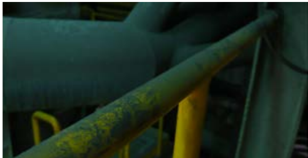
入料區附近欄杆上厚厚的粉塵。
