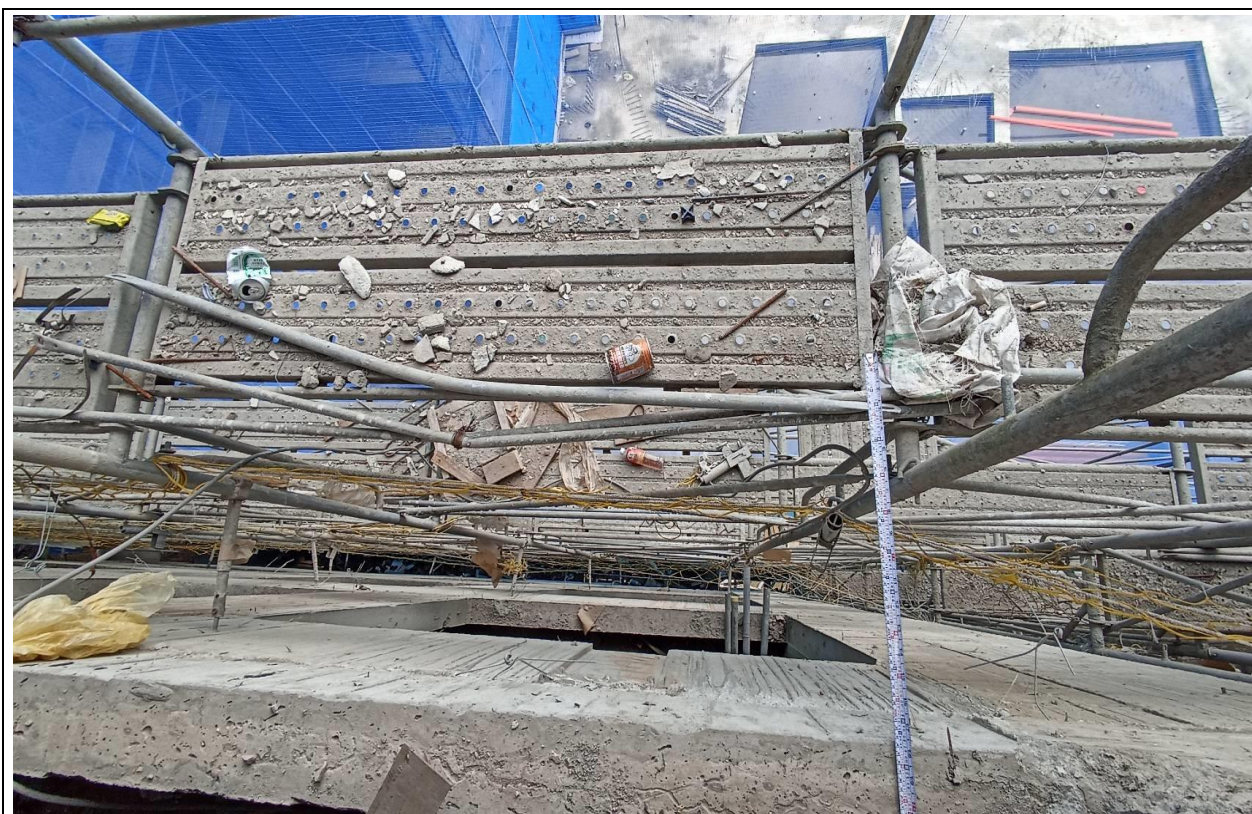
新北市某建築工地地上 5 樓至 8 樓外牆施工架及樓板邊緣開口，未設置護欄或安全網等防墜設施。
