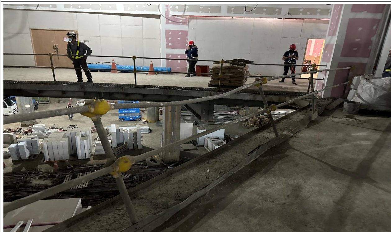
臺北市某建築工地上部結構鄰近開口之護欄明顯變形強度不足，有墜落危險之虞。
