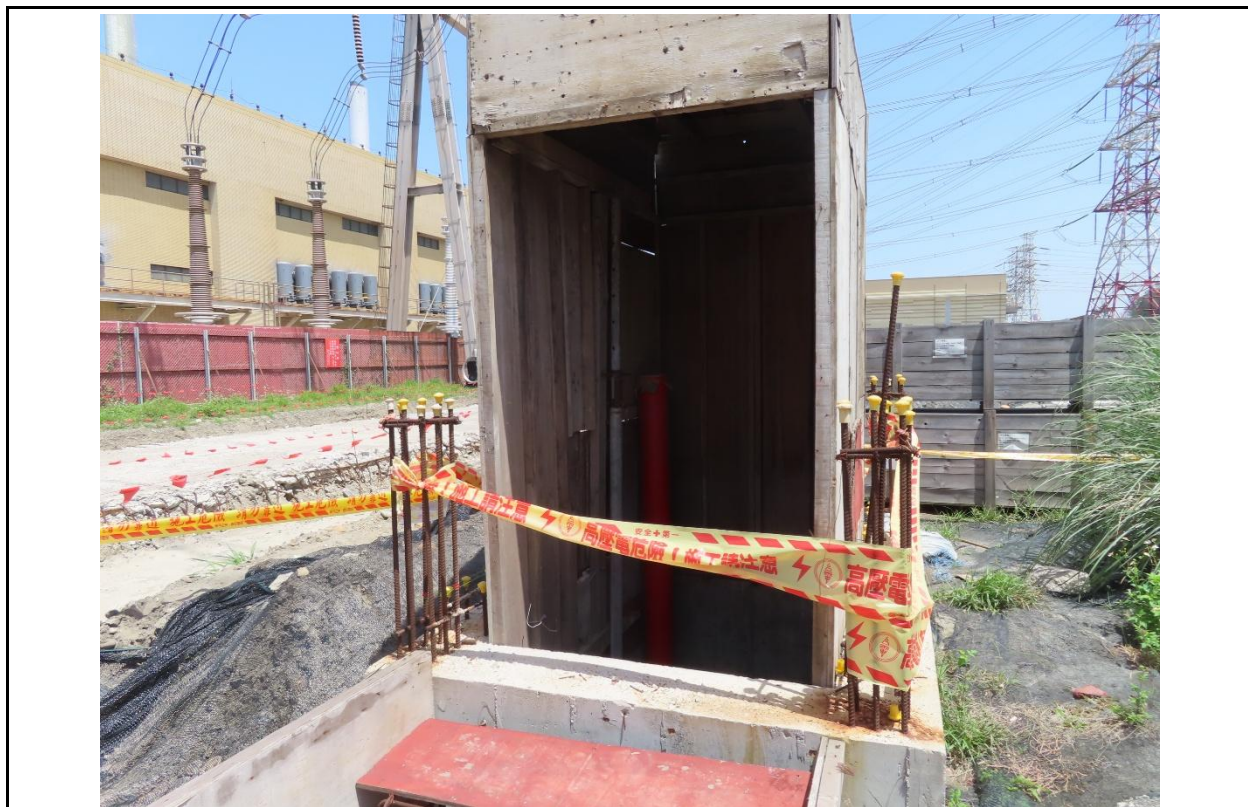
說明 相片1，災害發生處，通風及逃生孔。
