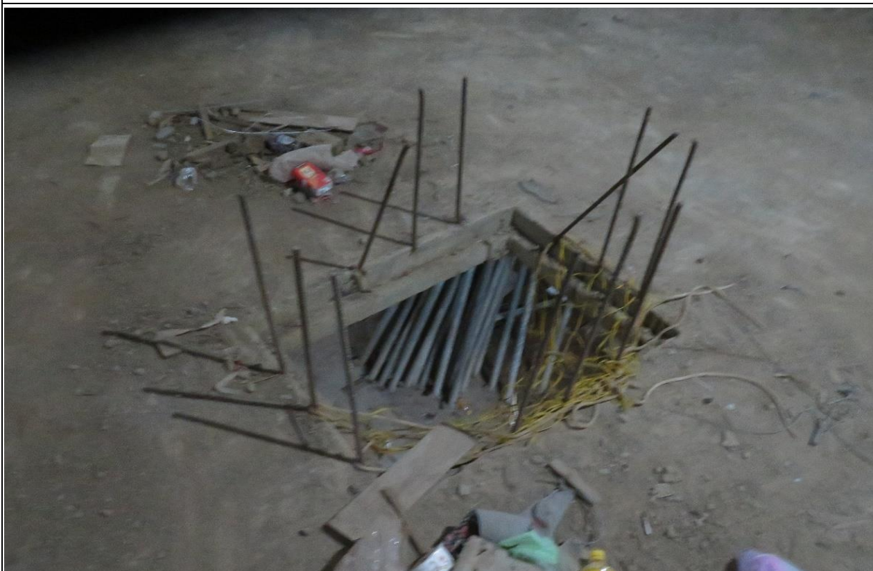
桃園市某建築工地地下室開口未設護欄、護蓋或安全網，樓板預留鋼筋未加裝護套。
