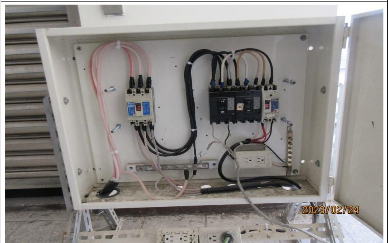
屏東縣某廠房增建工程使用電路未設置漏電斷路器。
