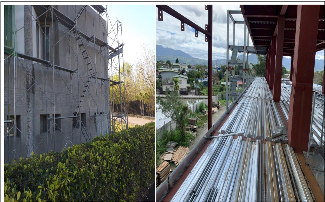
東部某建築工地外牆施工架工作臺及樓板邊緣等未設置護欄。
