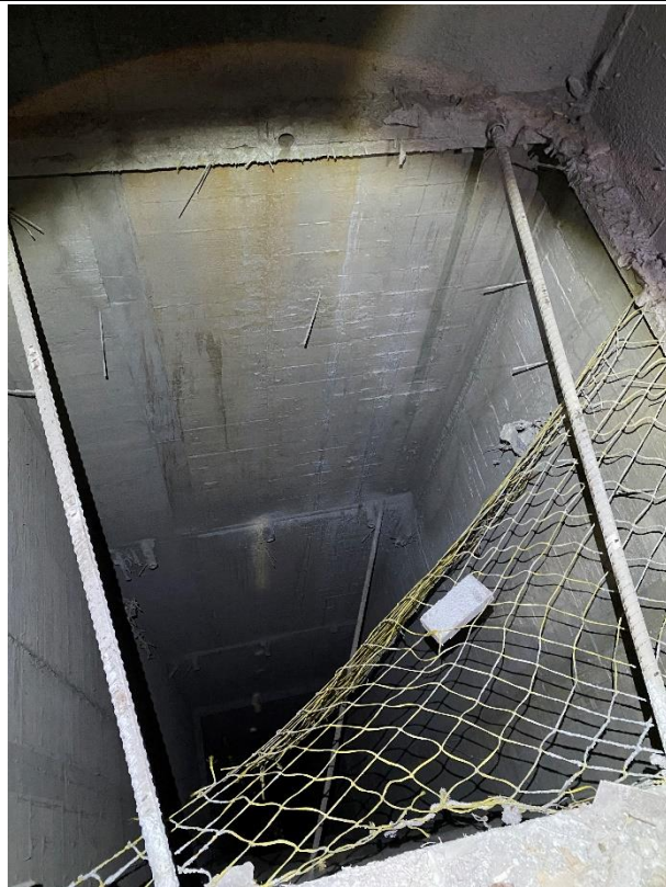
照片 2 電梯井內剩 2 根支承工作平台之鋼筋及殘留 2 邊之安全網，另有 1 根支撐鋼筋掉落並卡於 14 樓與 15 樓間。
