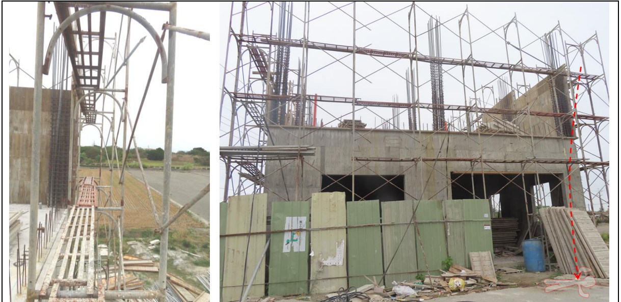
施工架工作臺寬度30公分及未設置護欄(未設內側交叉拉桿及雙側下拉桿)；罹災者自第4層施工架工作臺(高度6.8公尺)墜落至地面。
