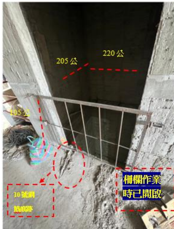
附照 1 D 棟屋突 1 層電梯井(罹災者江○○墜落處)，地上為 10 號鋼筋痕跡
