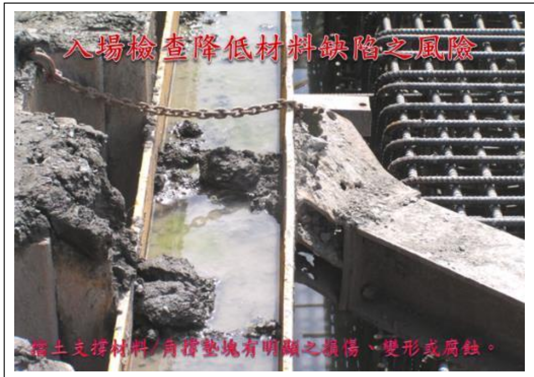
照片 19 擋土支撐之材料有明顯之損傷、變形
