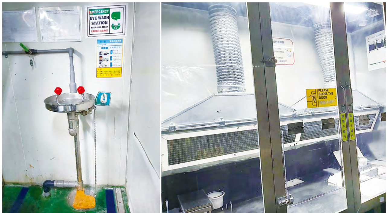
▲廠區內設置的緊急沖眼器與調墨區排油煙機
