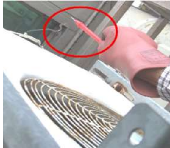
檢測之電線裸露情況
