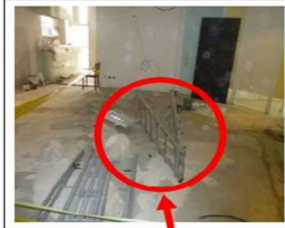
罹災勞工進行高度 2 公尺以上之作業，使用之合梯
