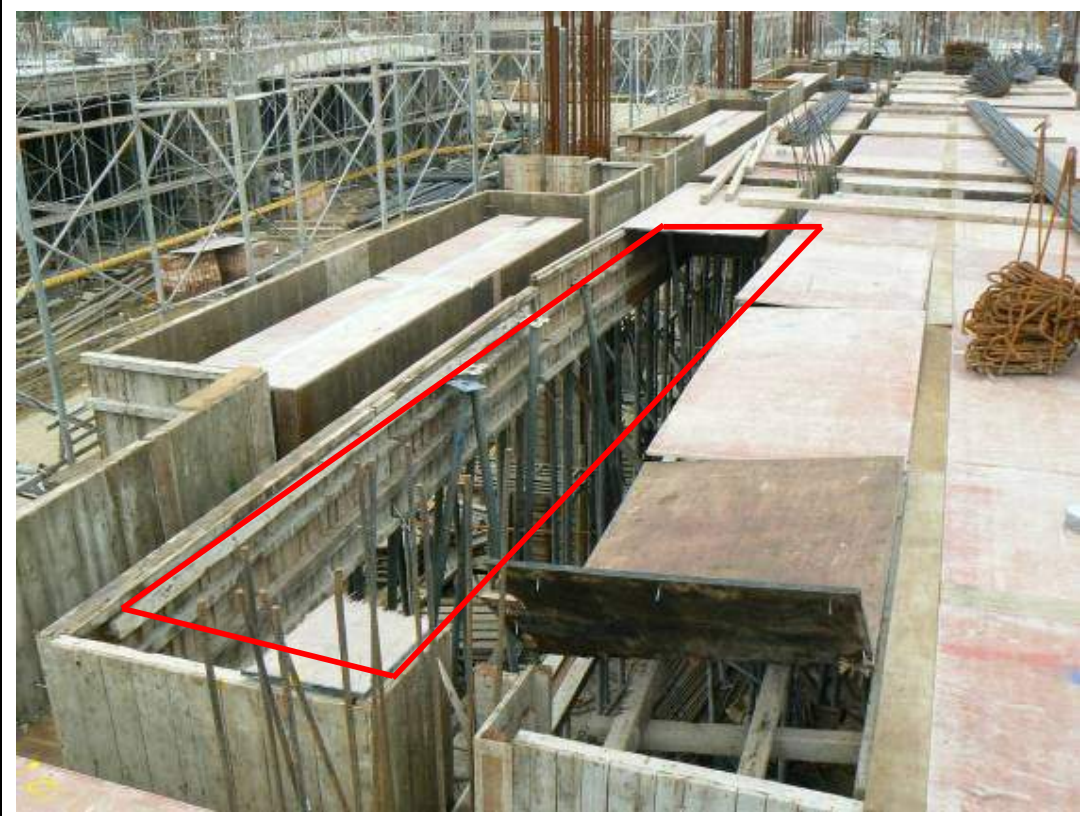
附照 災害發生位置 07 之 2 樓模板破壞情形。
