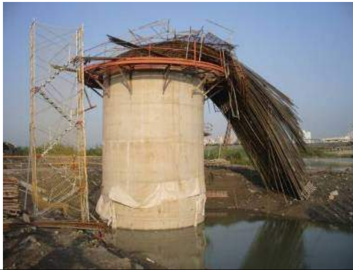
照片一 事故現場大漢溪旁P墩柱鋼筋倒塌情形。
