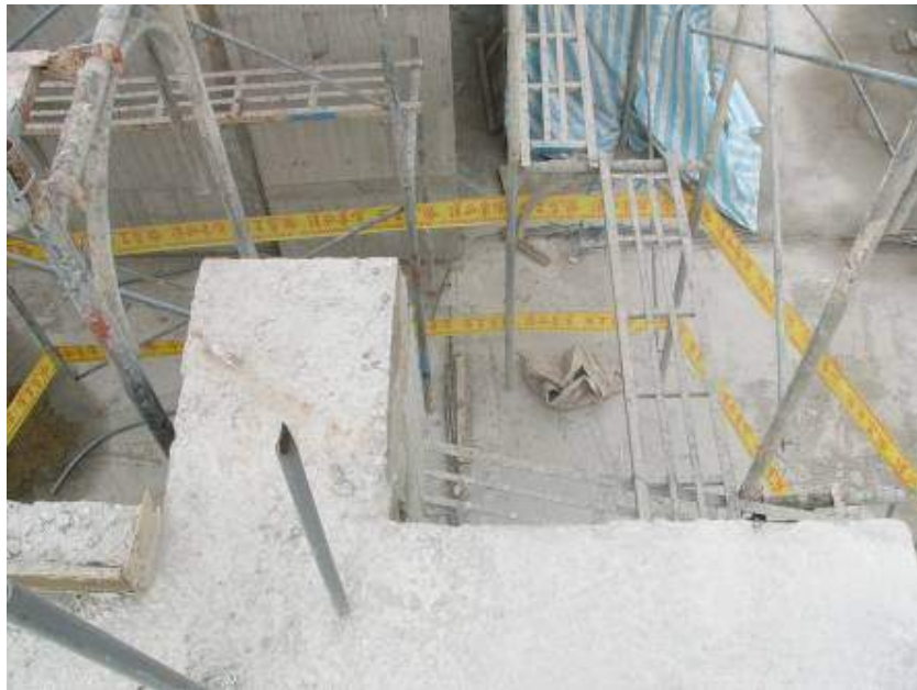
照片 2 屋突邊緣開口
