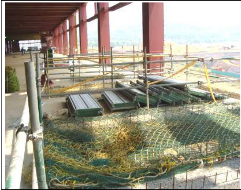
B21 棟 3 樓吊裝口堆置施工架腳踏板處
