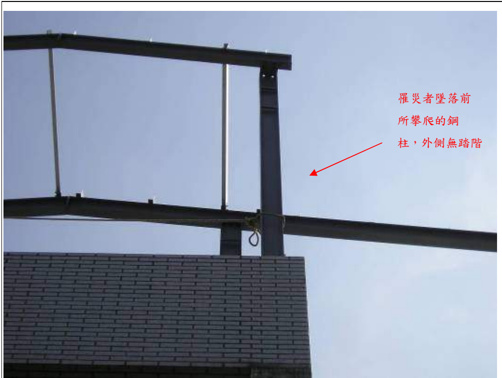
說明 附照 4 罹災者墜落時位置(攀爬的鋼柱朝外的一面無階梯可供攀爬)
