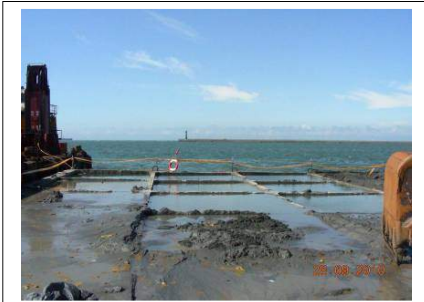
說明 照片 1 災害現場
