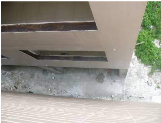
照片 2 水泥硬塊砸中在巷內行走的勞工
