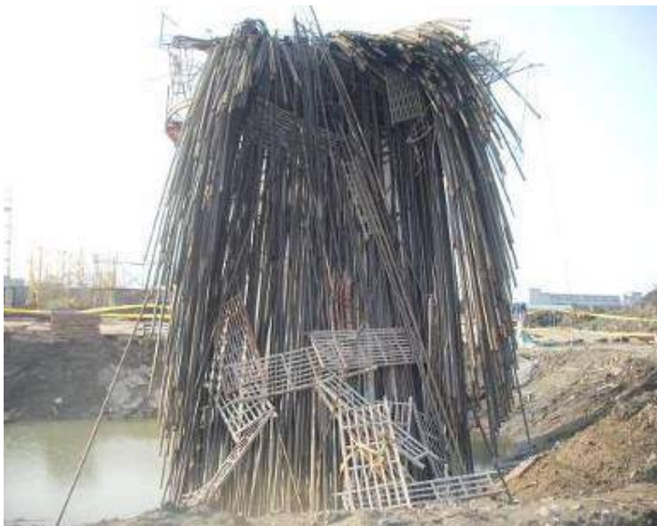
照片二 事故現場大漢溪旁P墩柱鋼筋倒塌情形。
