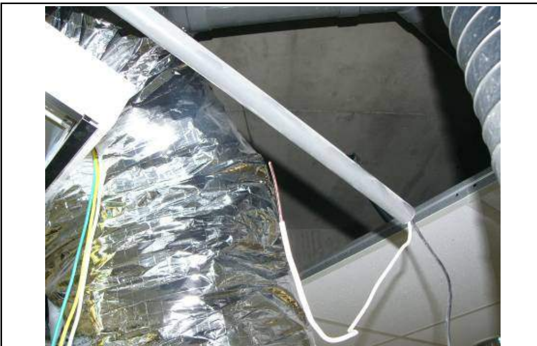
說明 附照 2，待接上空調抽風機之電源線路已有一條電線絕緣被覆被剝除。
