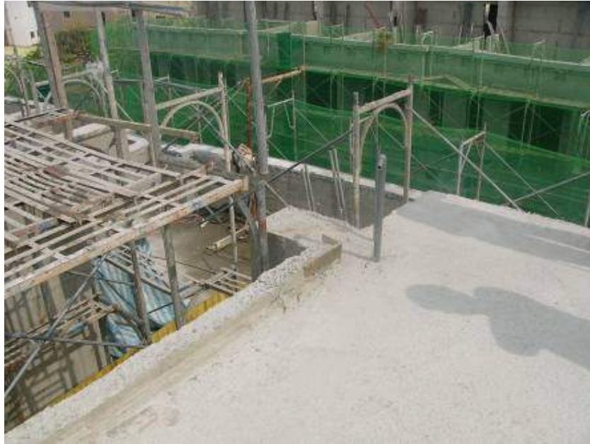
照片 1 災害現場屋突
