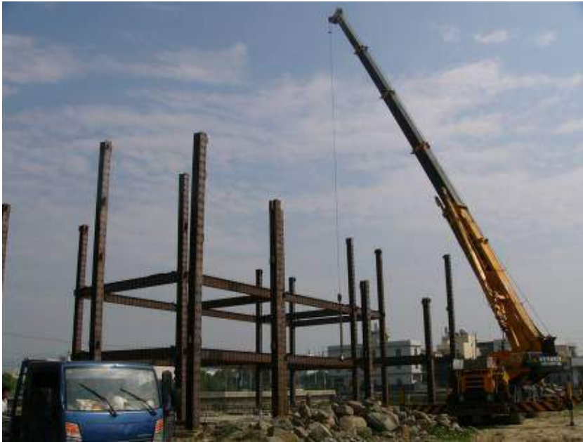
照片 1 災害現場鋼構
