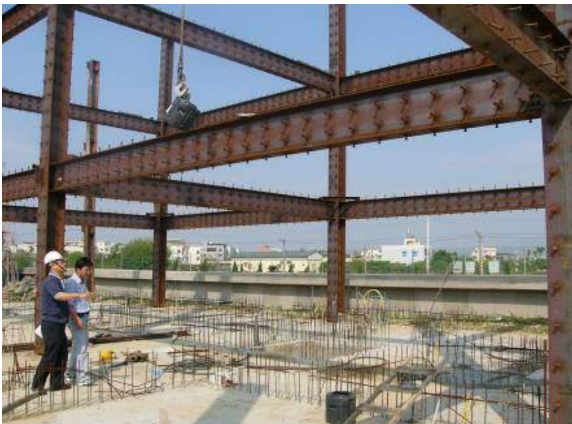
照片 2 螺栓桶撞及鋼樑上作業人員模擬
