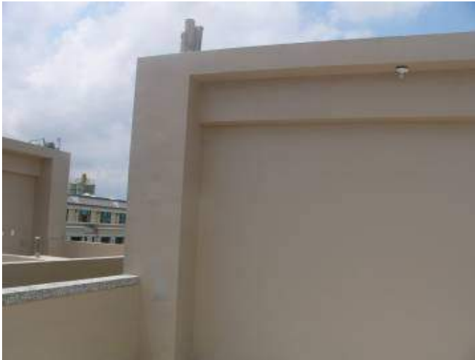
照片 1 水泥硬塊由屋突投下
