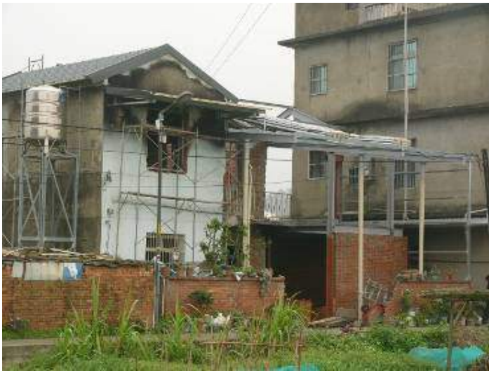
災害現場高約 6 公尺之屋頂。
