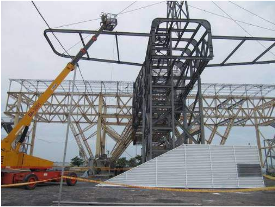
罹災者災害當時作業為飛機尾翼左側上方之2根斜拉桿之除銹油漆工作
