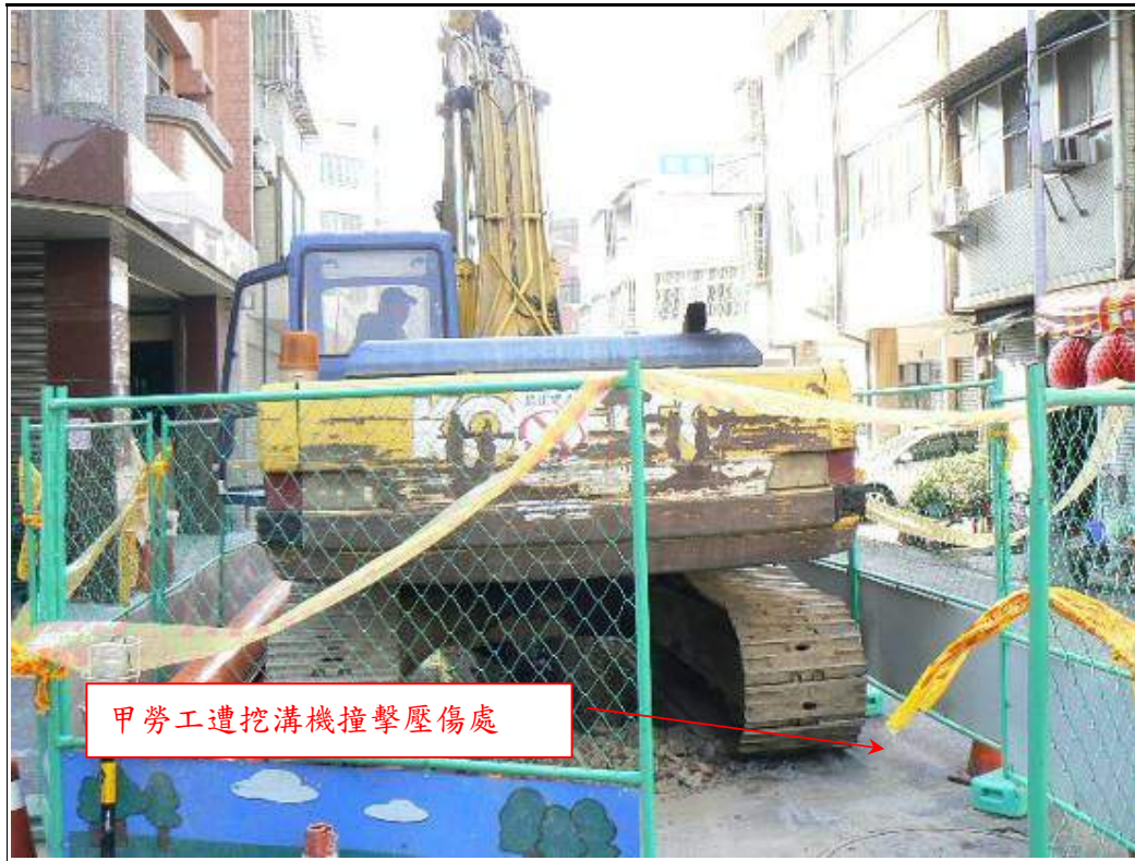
災害現場照片：甲勞工遭挖溝機撞擊壓傷處。
