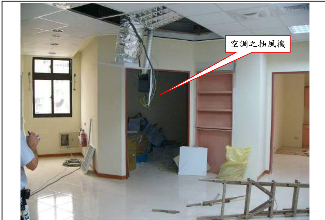
說明 附照 1，災害發生處，黑色垂掛設備為空調之抽風機；災害發生時罹災者使用之合梯(倒在地上)已損壞，現場已因急救、搶救不復原狀。
