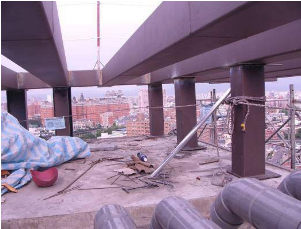
C 棟屋突 3 樓，距 1 樓地面約 50 公尺，型鋼高度約 1 公尺，有設置安全母索
