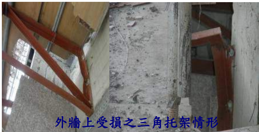
照片2：掉落及受損三角托架情形
