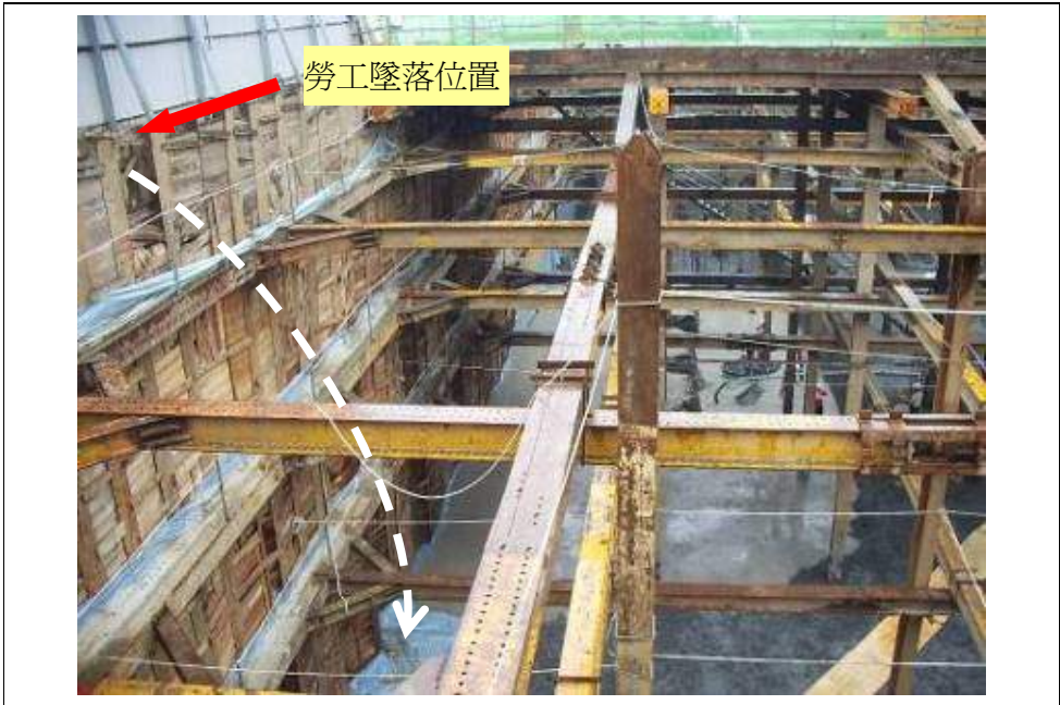
說明 災害現場立面照片
