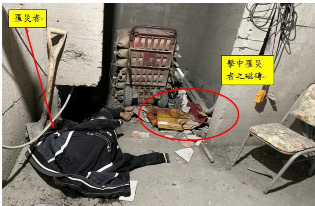
附照 2 罹災時現場照片(罹災者將另一臺裝載水泥之手推車推進電梯井內吊料平臺，遭上方掉落之磁磚擊中頭部致死)
