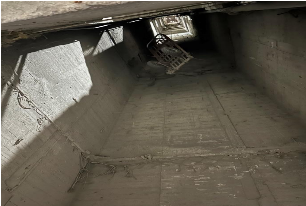
附照 1 災發當時吊掛手推車情況(停於地下 1、2 樓之間)
