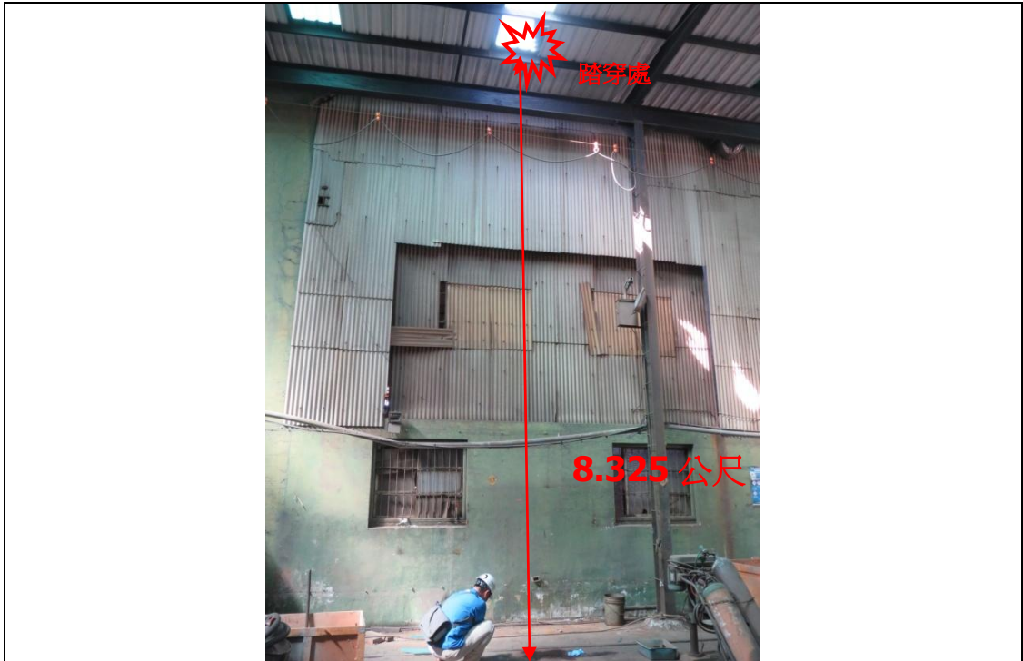
說明 照片 2：罹災者踏穿採光浪板墜落處距地面約 8.3 公尺
